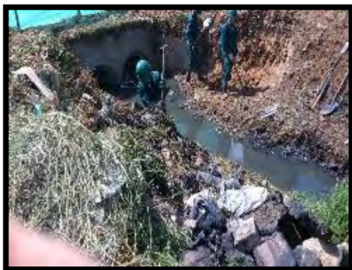
Imagen 55. Estado inicial del paso de la quebrada.
