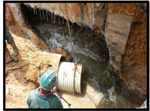
Imagen 100. Rotura de cámara y conexión de tubería.
