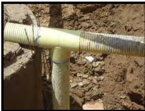
Imagen 73. Tee que da caída y conecta el tubo de llegada y el pozo.
