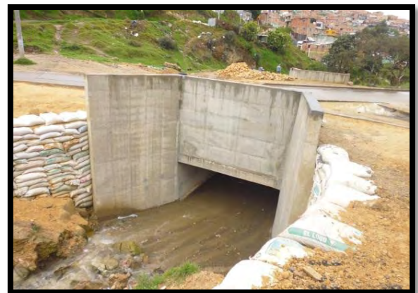
Imagen 60. Cabezal de salida y lonas de box culvert cra 18G quebrada Limas.
