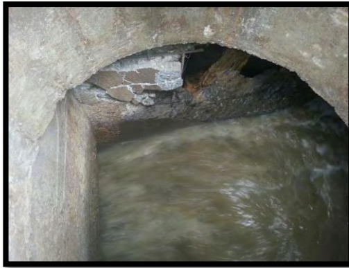
Imagen 99. Cámara de empalme sobre Av. Caracas.
