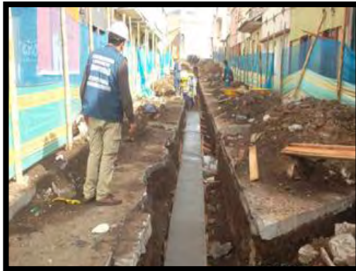
Imagen 33. Cárcamo de protección tubería de 10”.
