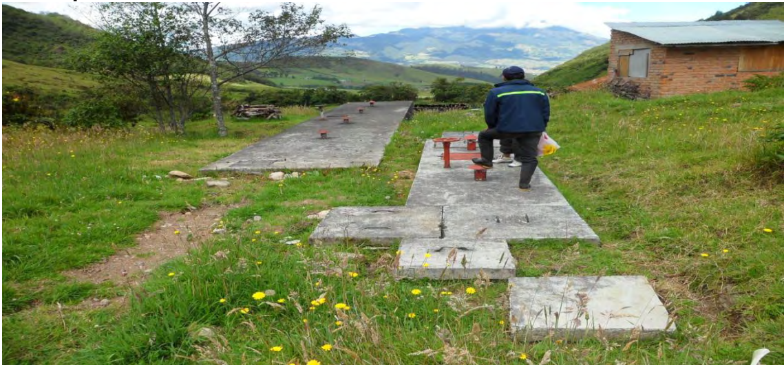
Figura 24. Desarenadores Uno y Dos del Corregimiento de Jamondino Municipio de Pasto.
