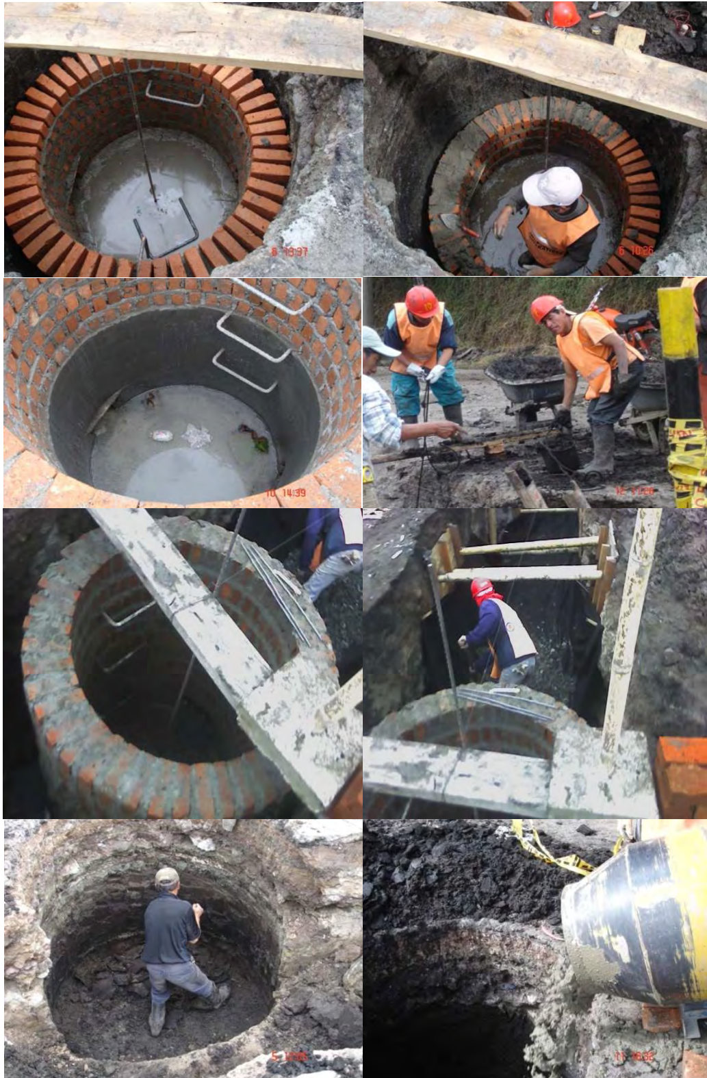
Figura 21 Cámaras de inspección
