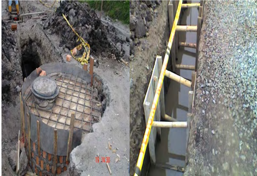
Figura 22 Cámaras de inspección
