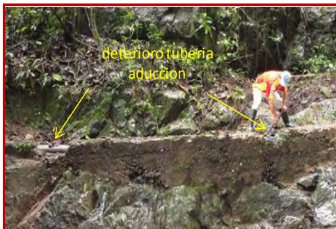
Tercera Bocatoma, Fuente Peñas Lisas. Deterioro de la Conduccion
