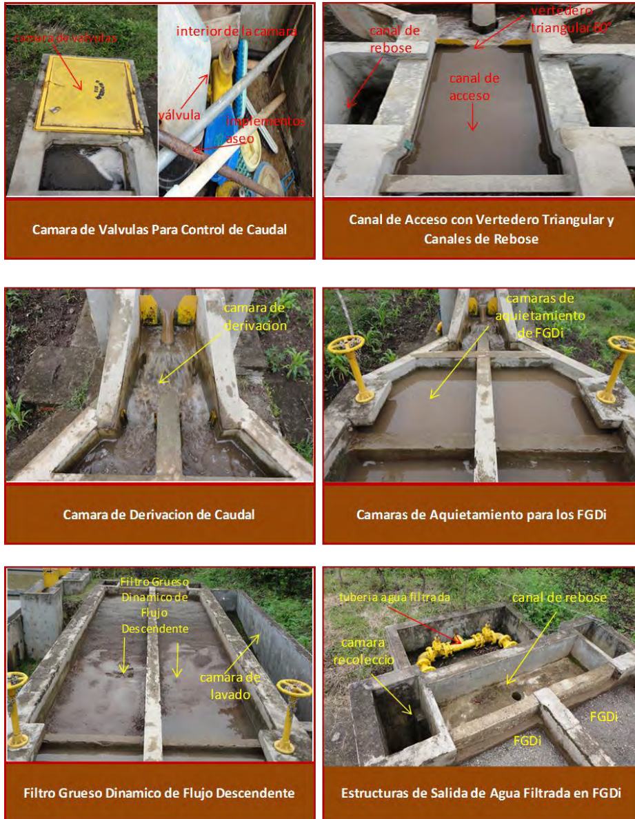
Figura 6. Detalle de la entrada y salida de agua del FGD
