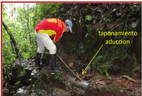
Tercera Bocatoma, Fuente Peñas Lisas. Taponamiento de la Conduccion
