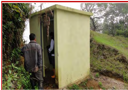
Camara de Quiebre - Conduccion Fuente La Chorrera y Aduccion Fuente La Pajosa
