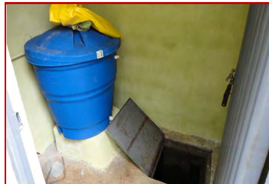
Camara de Quiebre - Conduccion Fuente La Chorrera y Aduccion Fuente La Pajosa
