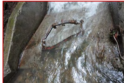
Tercera Bocatoma, Fuente Peñas Lisas. Deterioro de la Rejilla
