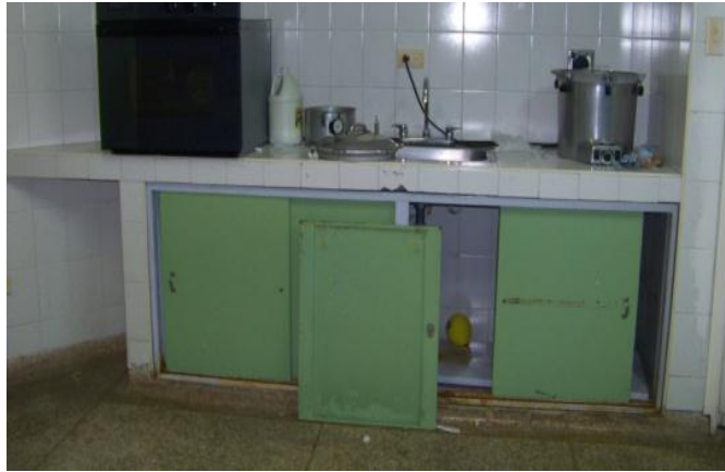
Figura 4. Instalaciones en mal estado
