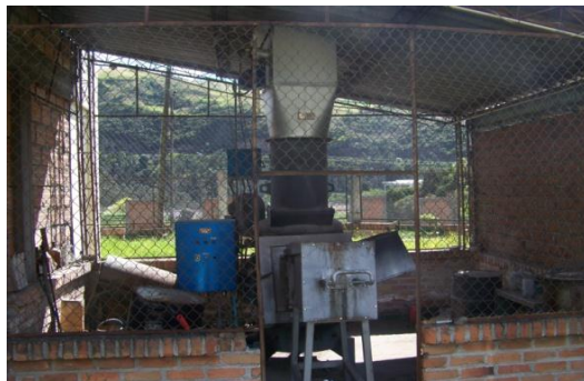
Figura 9. Tanques de abastecimiento de agua sin utilizar
