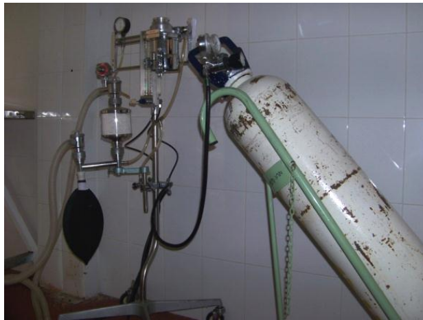
Figura 7. Equipo de Gases en mal funcionamiento
