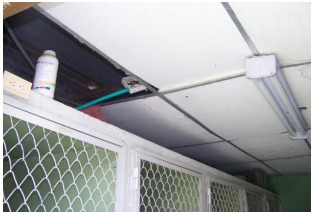
Figura 5. Perreras con daños eléctricos
