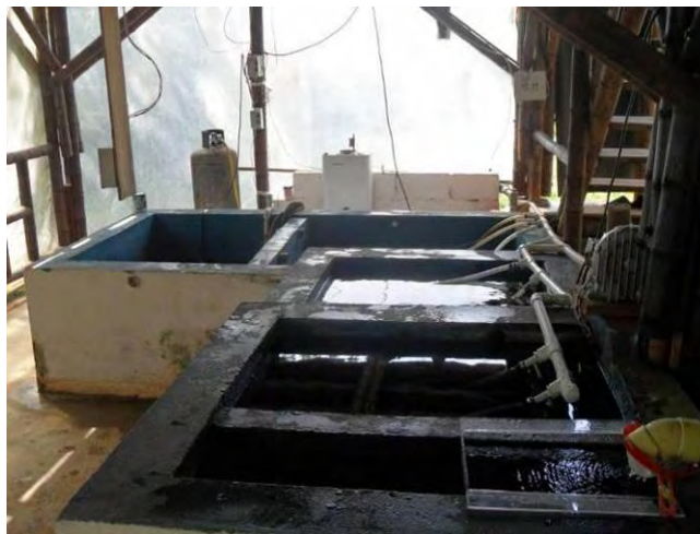
Figura 26. Reactor de pantalla y filtro biológico.
