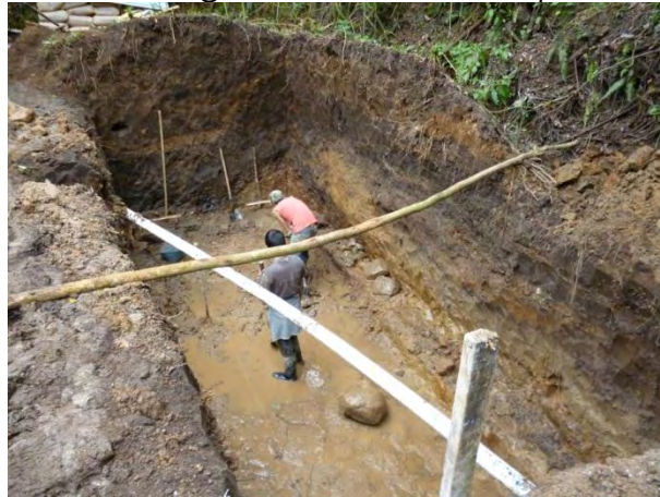
Figura 40 Aparición de agua en excavación para el desarenador
