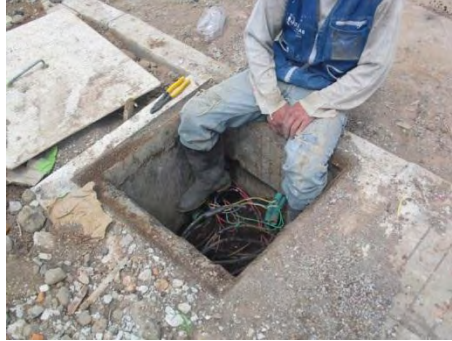
Figura 59 Cableado para red de baja tensión subterránea
