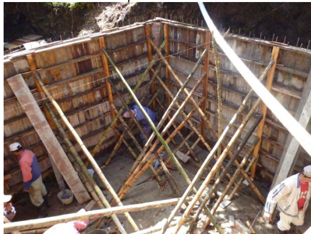
Figura 30 Armado y apuntalamiento de formaleta para fundición de paredes de tanque de almacenamiento
