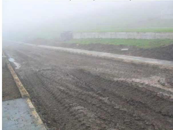
Figura 54 Estado vía principal en época de lluvias
