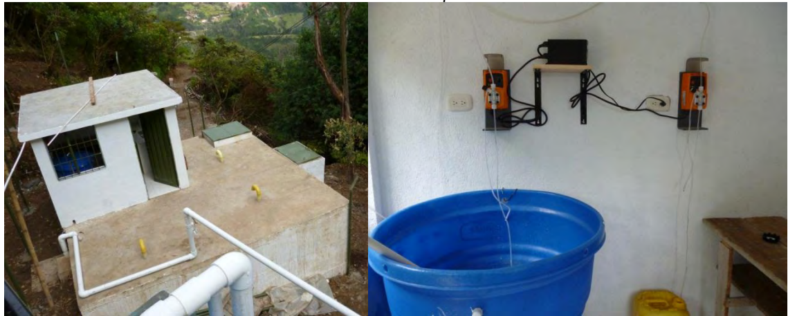
Figura 33 Caseta de cloración terminada/Sistema de dosificación de químicos
