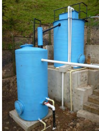
Figura 28 Vista general de la PTAP
