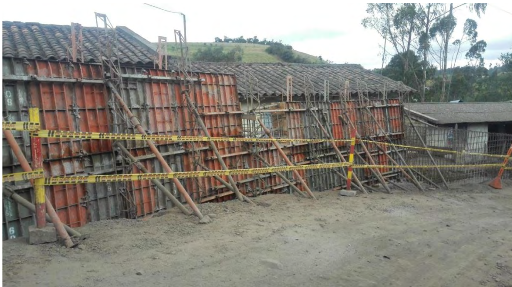
Figura 37. Muro de contención con módulo 2 formateado.
