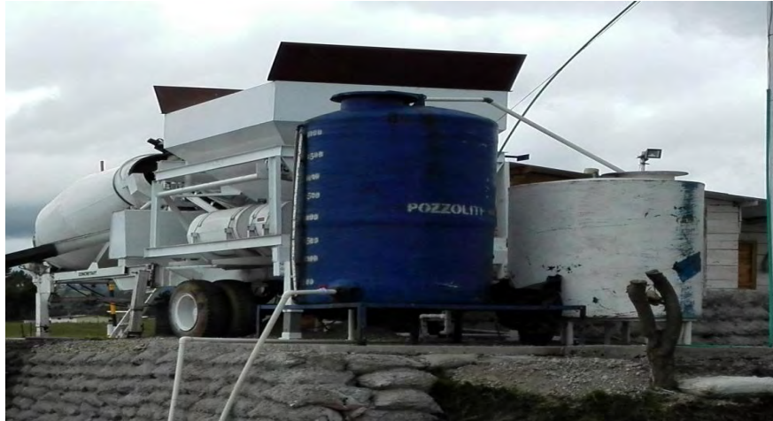
Figura 15. Tanques para almacenamiento de agua.
