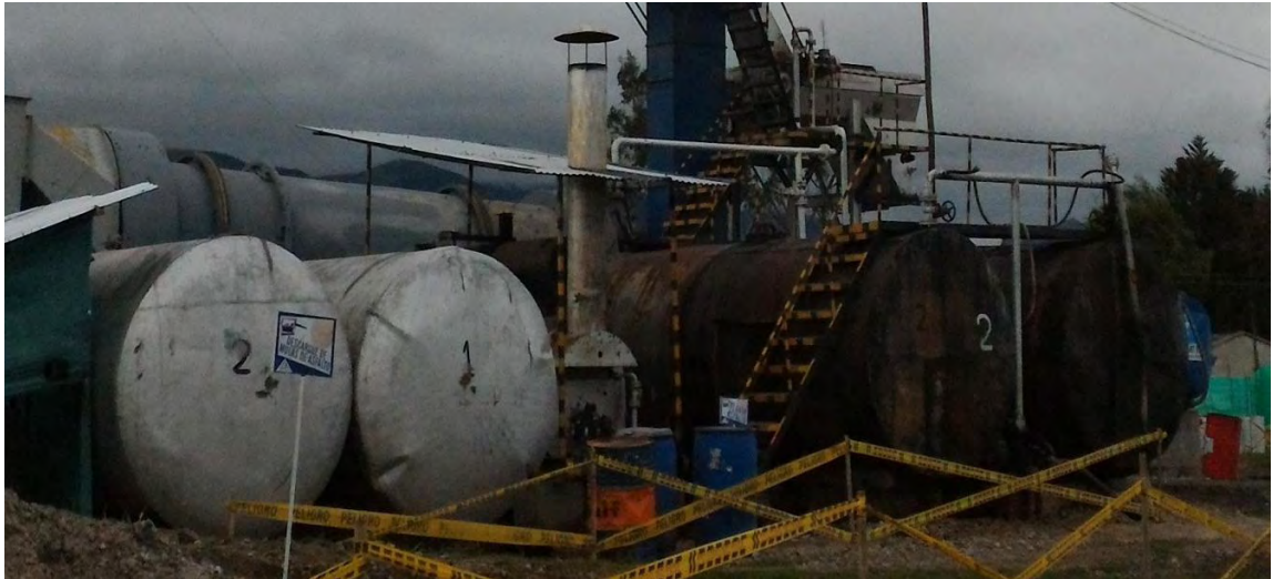
Figura 25. Tanques de combustóleo (Fuel-Oíl), caldera y tanques de asfalto.
