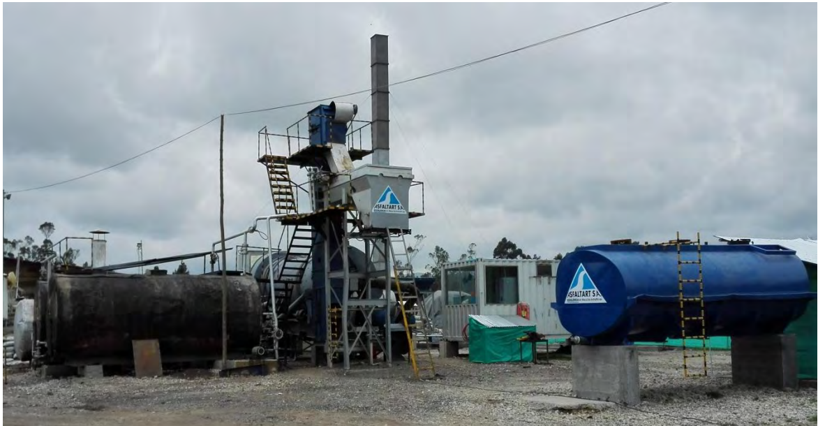
Figura 19. Planta móvil de Asfalto Parker.
