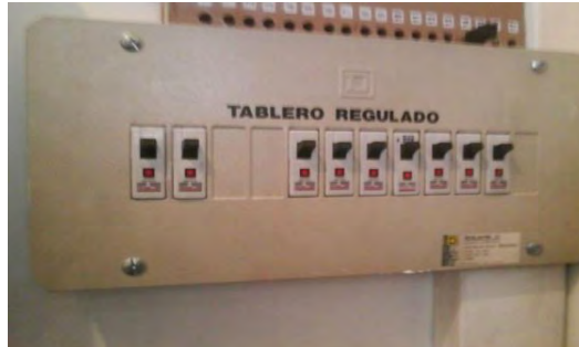
Ilustración 42. Tablero de distribución de energía regulada
