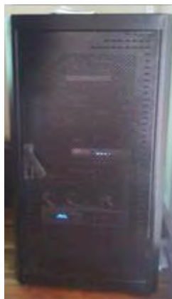
Ilustración 43. Gabinete de telecomunicaciones
