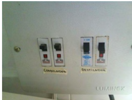
Ilustración 41. Tablero de distribución eléctrica para el destilador y el coagulador pertenecientes al Laboratorio de Micobacterias
