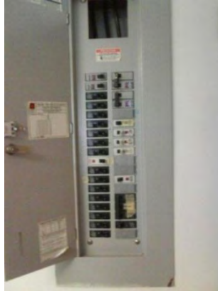
Ilustración 40. Tablero de distribución eléctrica en el Laboratorio Clínico
