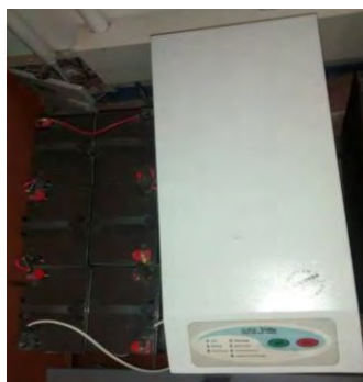
Ilustración 45. Sistema de alimentación ininterrumpida (UPS) del LSP
