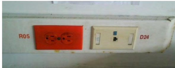
Ilustración 44. Canalización para recorrido eléctrico y de datos
