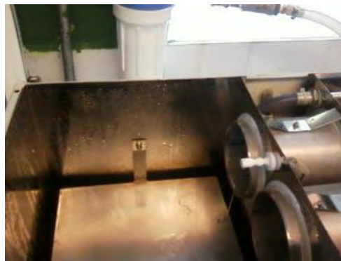
Ilustración 23. Tanque generador de vapor Destilador GFL
