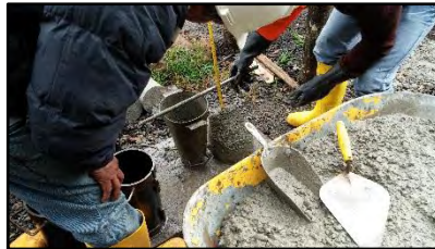
Figura 34. Toma de asentamiento con cono de abrams durante vaciado de concreto en las obras realizadas del trayecto 3.
