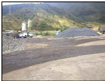
Figura 12. Planta de concreto ubicada en el túnel de daza.
