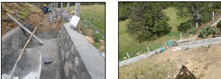
Figura 21. Canal enrocado de descole de dissipador PR0+700.
