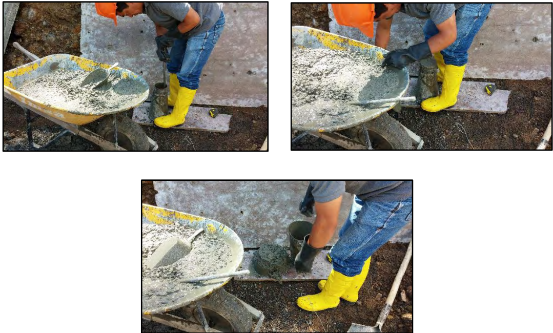
Figura 28. Toma de asentamiento con cono de abrams durante vaciado de concreto en las obras realizadas del trayecto 6-1.
