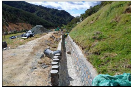
Figura 16. Toma de cilindros de concreto para ensayo de resistencia a la compresión en las obras del trayecto 5A.
