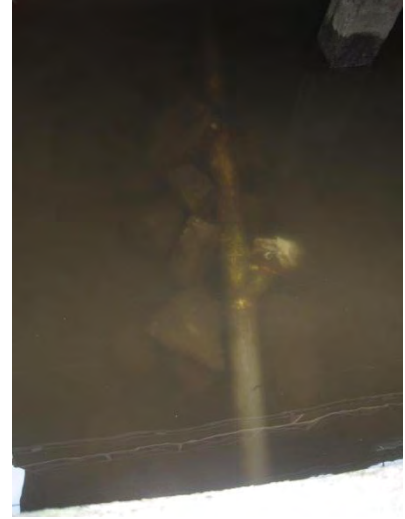
b. Tubería bajo el agua
