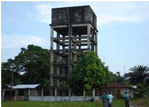
a. Tanque de almacenamiento
