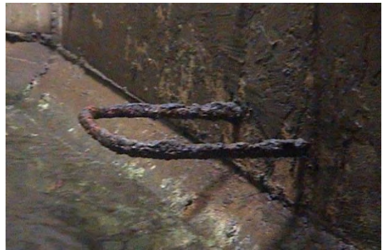
b. Acero corroído en el tanque
