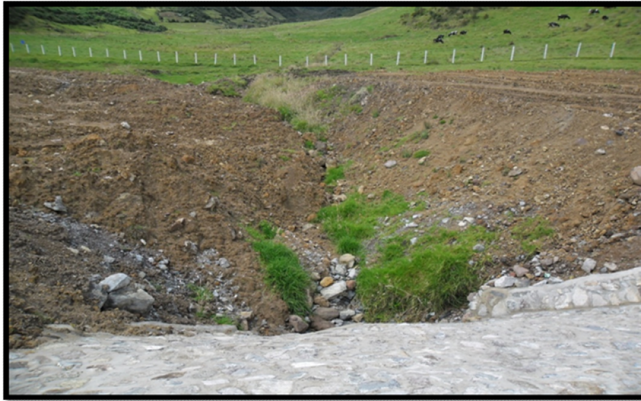
Figura 4. Erosión de material sustraído a un afluente de la quebrada
