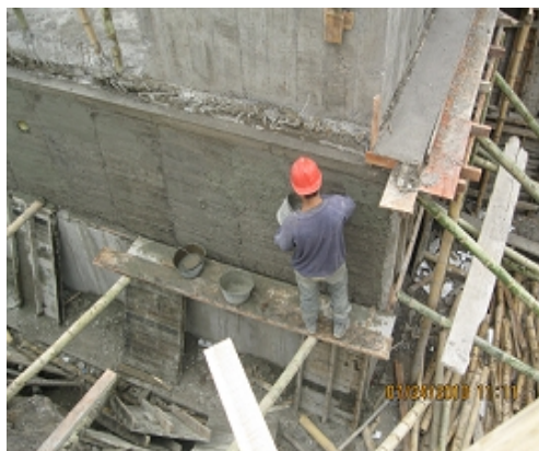
Fotografía No. 84. Pañete impermeabilizado aplicado al intradós del muro de contención – eje 5 zona norte.
