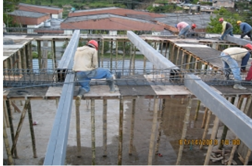
Fotografía No. 62. Instalación de tubería conduit 1/2", losa de entrepiso N+6.00 zona centro.
