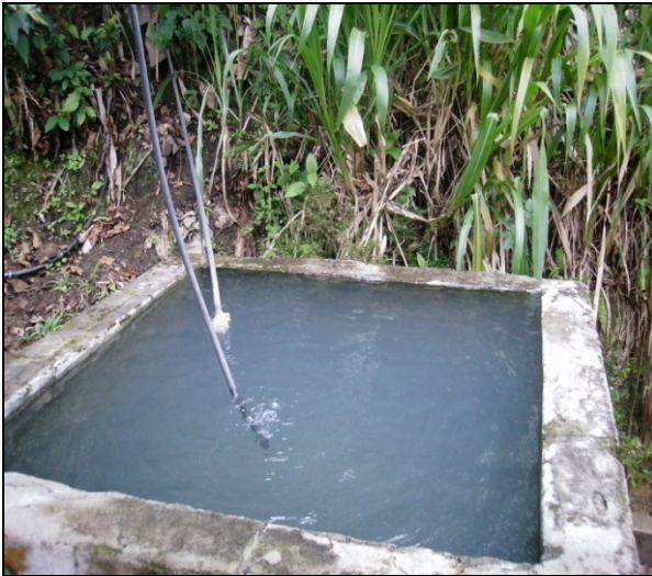
Captación de agua de una quebrada en la vereda Cusillos bajo.
