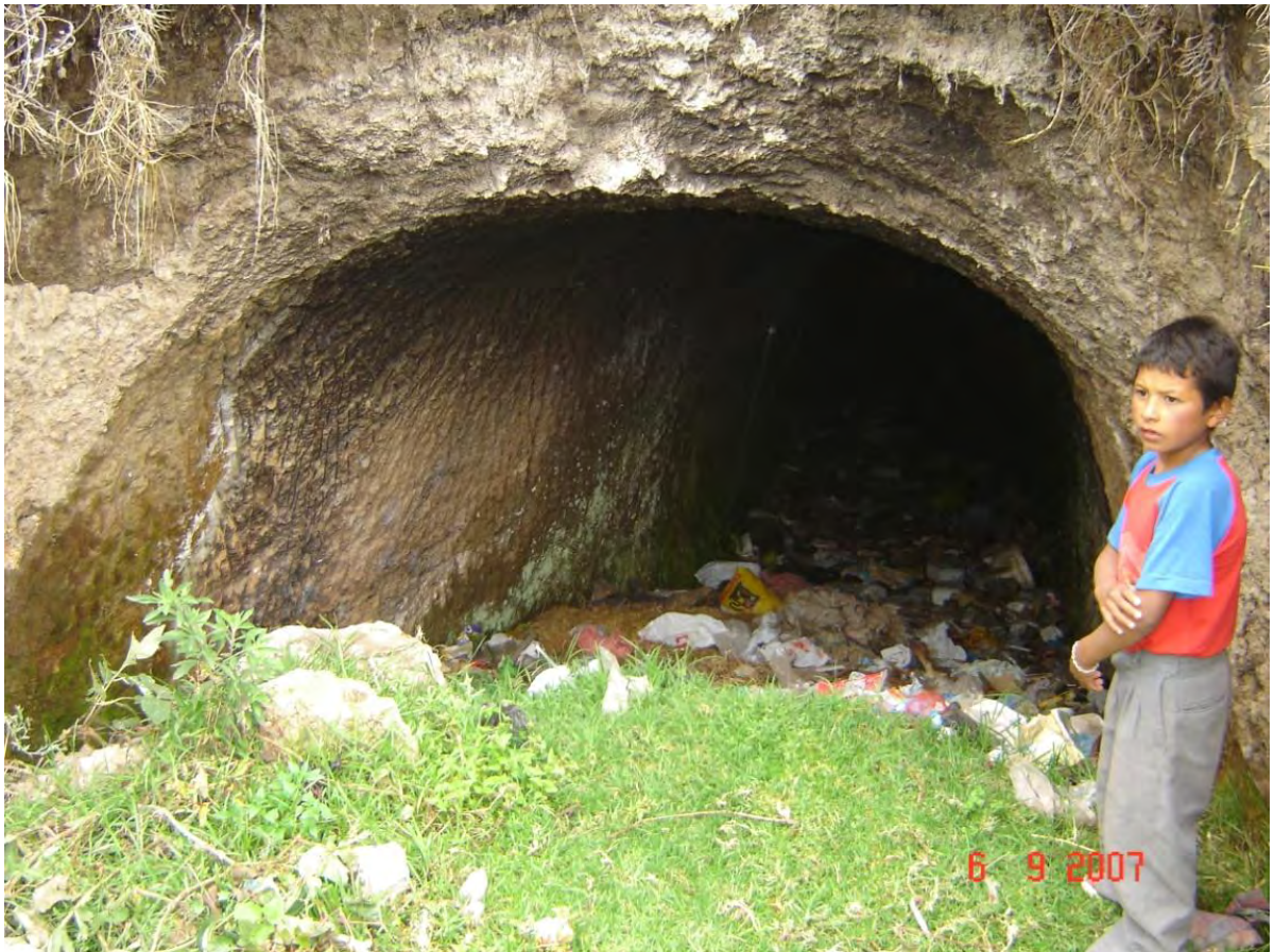
Fotografía 7. Área de Socavones, Barrio Albergue del Sol
