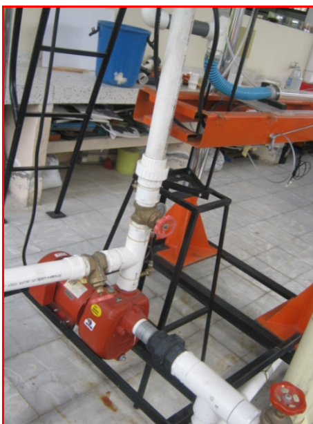
Fotografía 5. 8. Bomba y válvulas para el suministro y regulación del caudal líquido.
