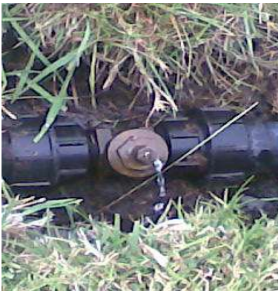
Fig. 4 (Fuga por válvula de control)
