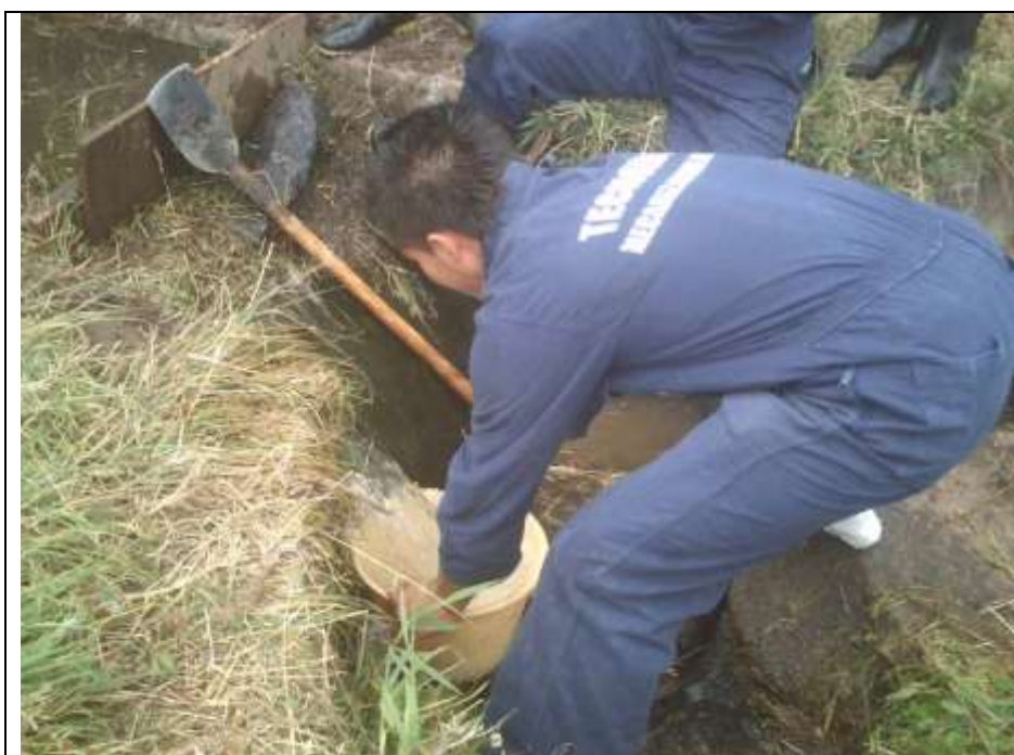
Aforo volumétrico en bocatoma
