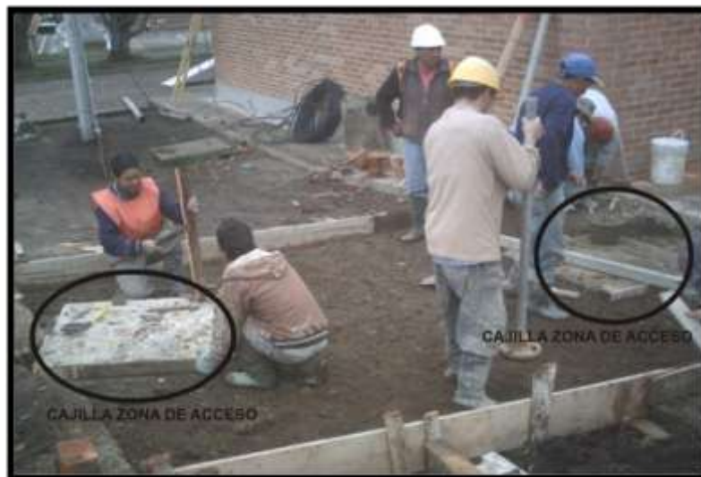
Figura 107 Cajillas en zona de acceso
