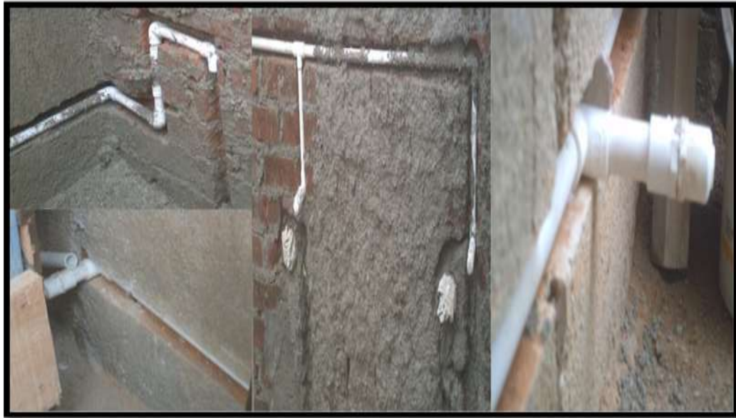
Figura 82 Instalación hidráulica en tubería PVC de 1/2"
