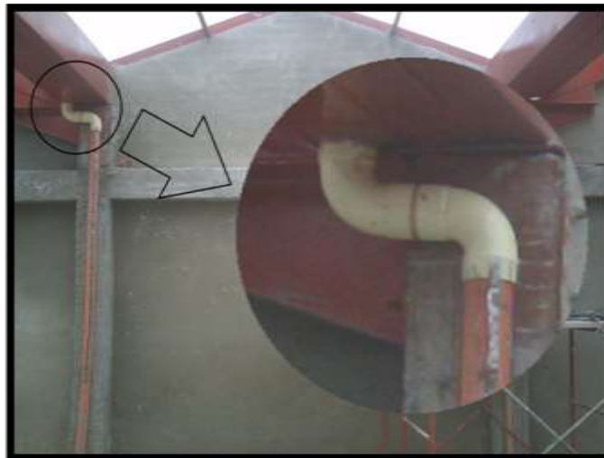
Figura 99 Puntos de aguas lluvias en PVC de 3"
