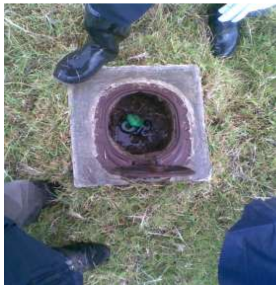
Fig. 5 (Localización de hidrante)
