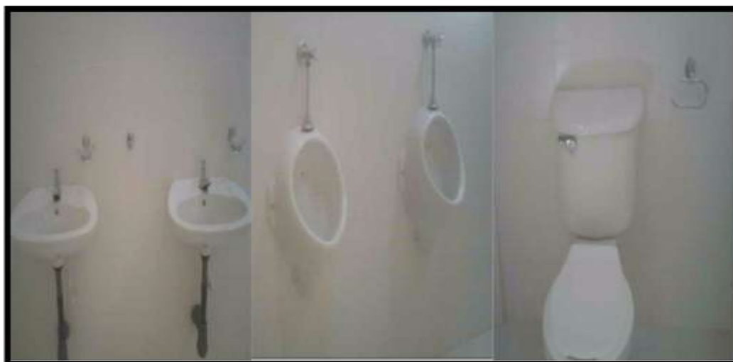
Figura 103 Lavamanos, orinales y sanitarios
