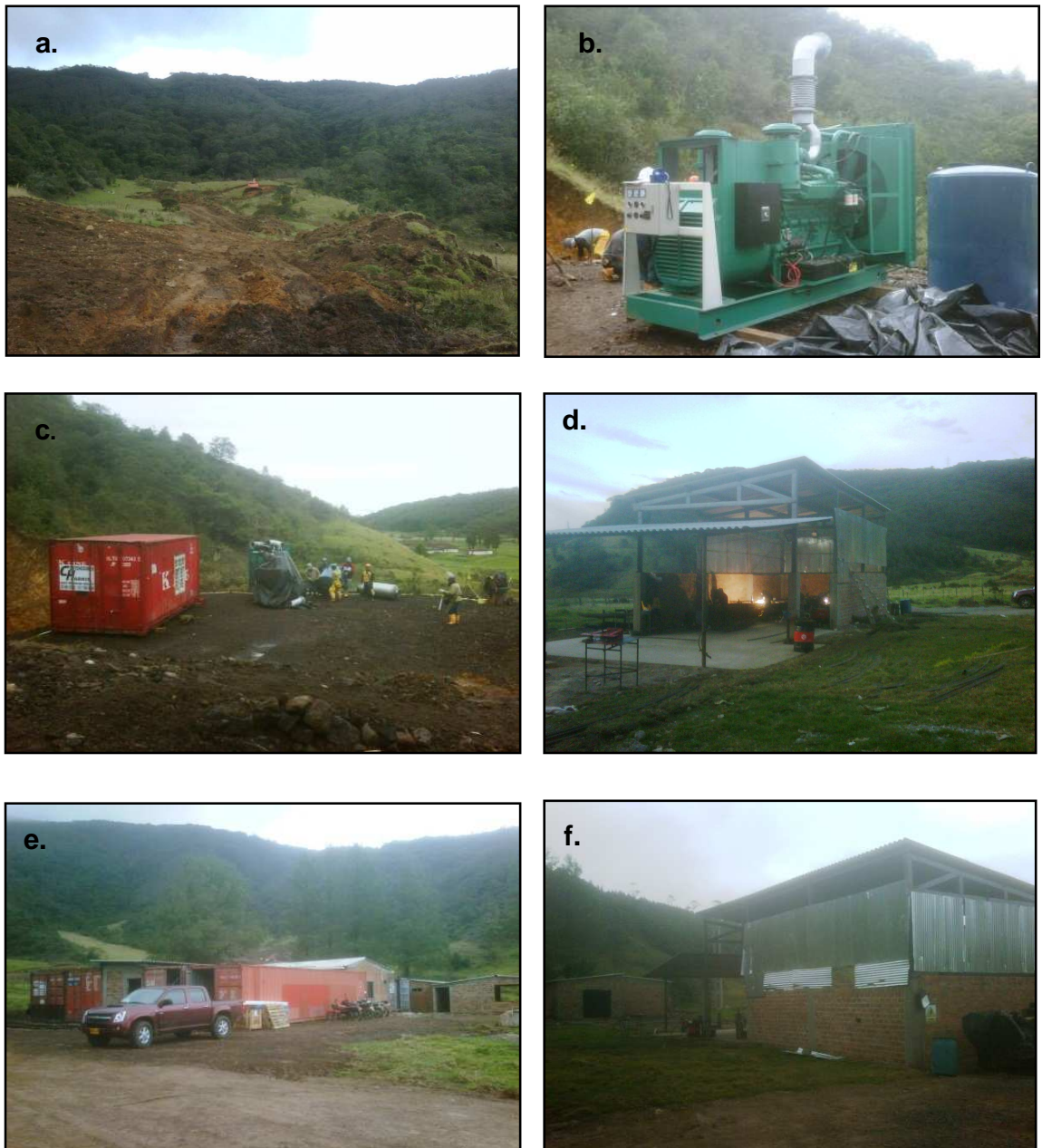
Figura 35. (a) Acceso a la zona de trabajo. (b) Planta electrica. (c) Adecuación zona de oficina dirección de frente. (d) Taller de soldadura y fabricación de arcos. (e) Construcción zona de oficinas, almacén y casino. (f) Adecuación taller y subestación eléctrica.
