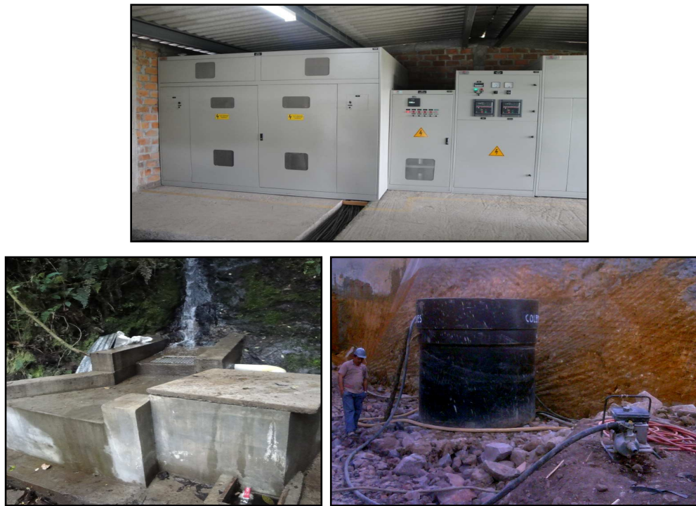
Figura 36. Subestación eléctrica y acueducto del proyecto.
