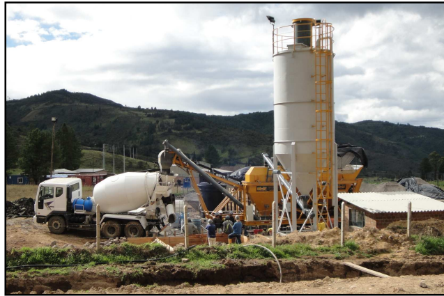
Figura 54. Proceso de preparación para el concreto lanzado. (a) Planta dosificadora. (b) revisión del lanzador. (c) lanzamiento de concreto.
