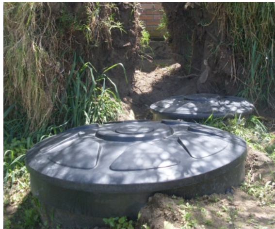
Figura 50. Tanque prefabricado que funciona como pozo séptico.
