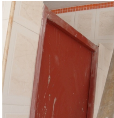
Figura 151. Puertas de acceso a duchas.
