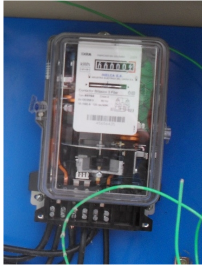
Figura 169. Instalación contador bifásico.
