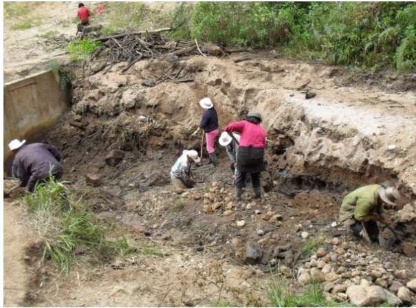
Figura 55. Remoción de deslizamiento en el puente vereda Quebrada Blanca.
