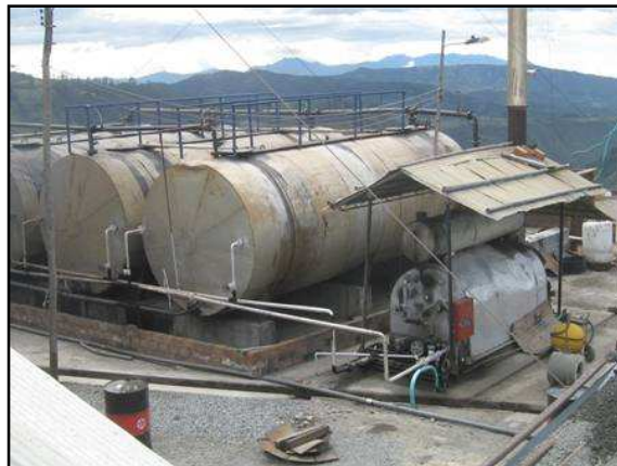
Figura 44. TANQUES DE ALMACENAMIENTO DE ASFALTO.
