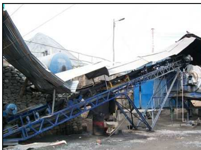
Figura 48. BANDA TRANSPORTADORA INCLINADA SEMIPORTATIL
