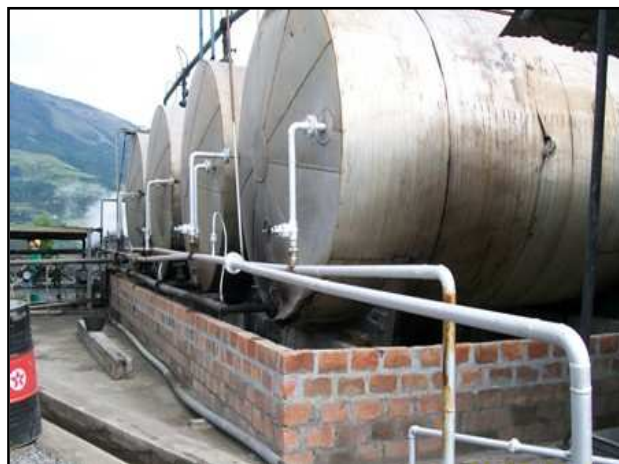
Figura 52. TUBERÍA CORRESPONDIENTE A LOS TANQUES DE ASFALTO
