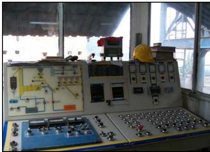
Figura 55. TABLERO DE CONTROL
