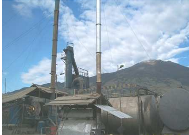
Figura 40. PLANTA DE PRODUCCIÓN DE MEZCLA ASFÁLTICA EN CALIENTE
