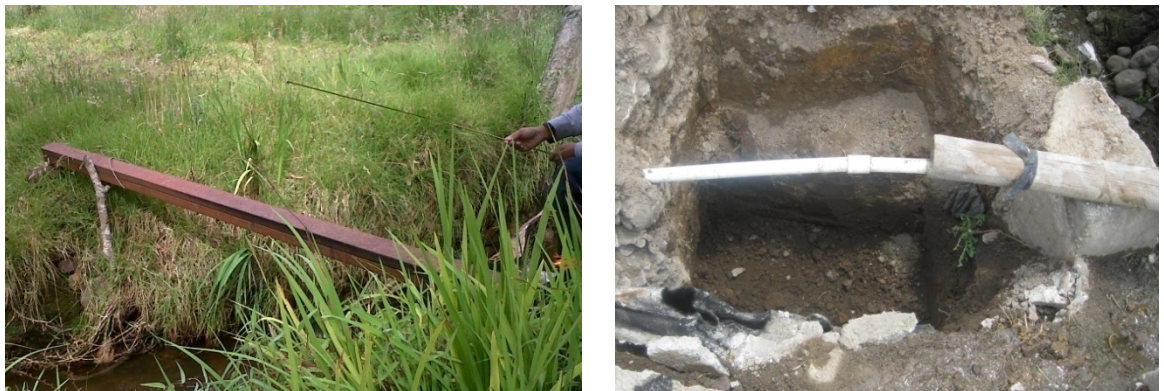
Figura 19. Perfiles en C y otros elementos utilizados como soporte de la conducción del acueducto.
