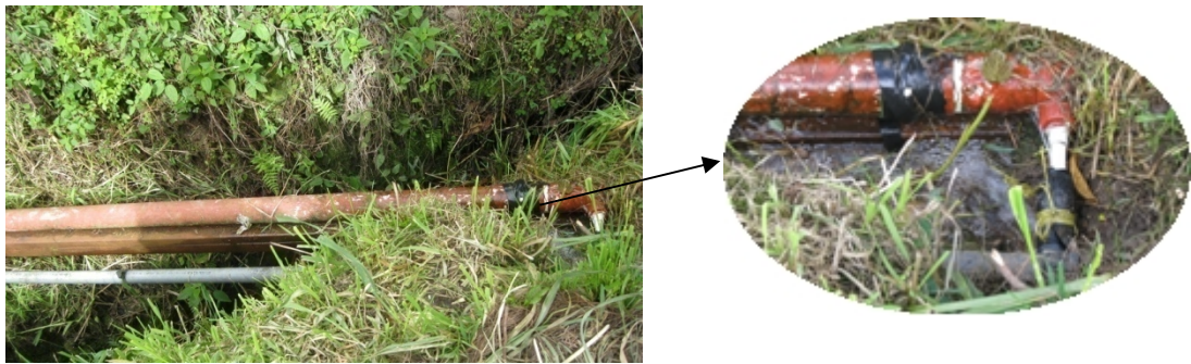
Figura 18. Problemas generados por la falta de un soporte con especificaciones técnicas.
