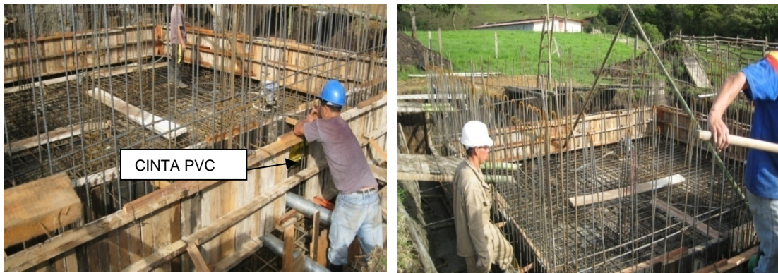
Figura 6. Armado de la cimentación y muros laterales hasta la altura de la cinta PVC
