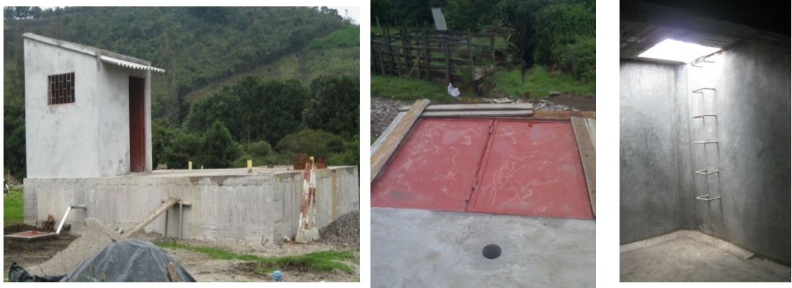
Figura 12. Caseta de cloración y accesorios del tanque.
