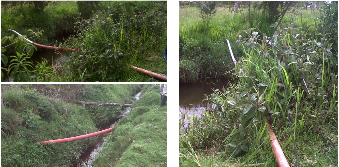
Figura 20. Problemas en la tubería colgante (deformaciones y cambios de sección).
