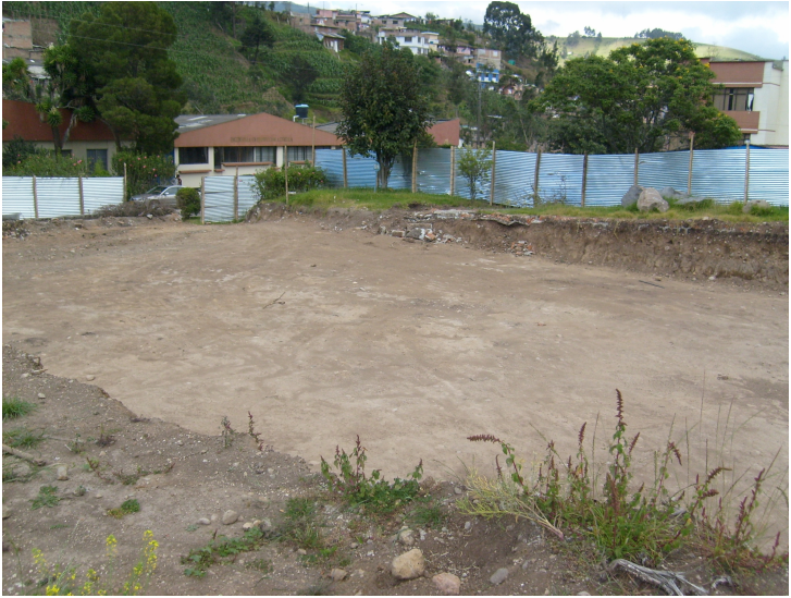
Ilustración 1 Estado inicial de la obra terreno en donde se comenzaría la construcción.
