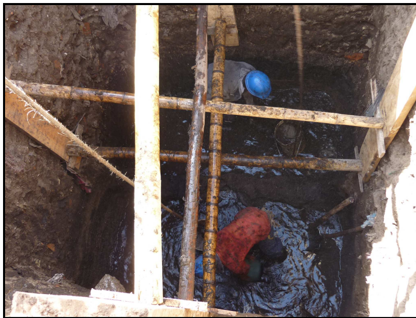
Fotografía No 39: Presencia de nivel freático
