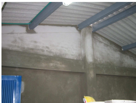
Figura 60. Utilización de perfil PHR en cajón para la estructura de la cubierta
