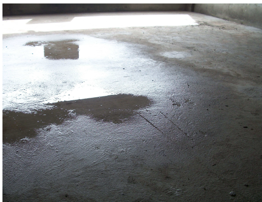
Figura 100. Filtración de aguas lluvias en la parte interna de las aulas
