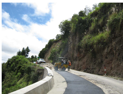
Figura 133 Disposición y compactación del concreto asfáltico para terminación final de la obra
