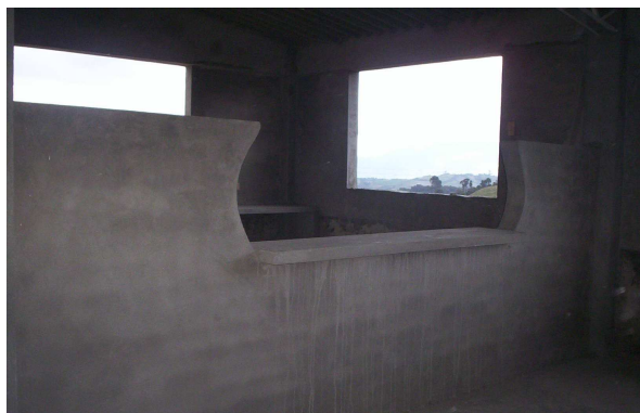
Figura 20. Estado inicial de la cocina del restaurante escolar
