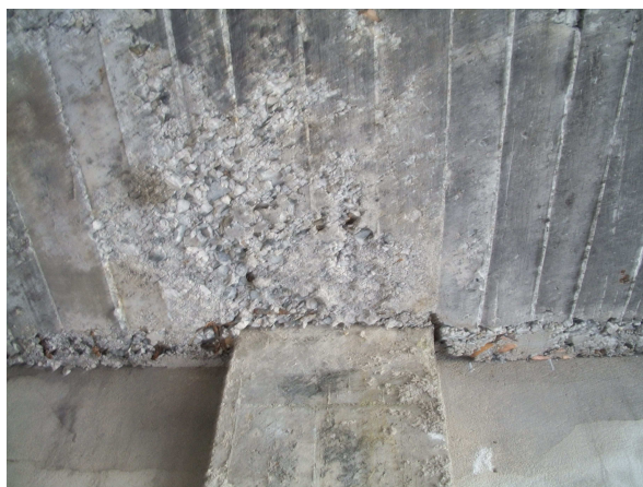
Figura 103. Evidencia de hormigueros
