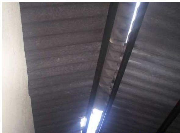
Figura 40. Estado actual de la cubierta del Salón comunal Cuaspud Núcleo
