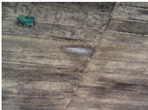
Figura 101. Filtración en la losa
