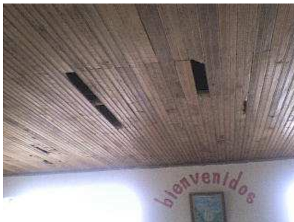
Figura 29. Estado del cielo raso del centro educativo Yamuesquer
