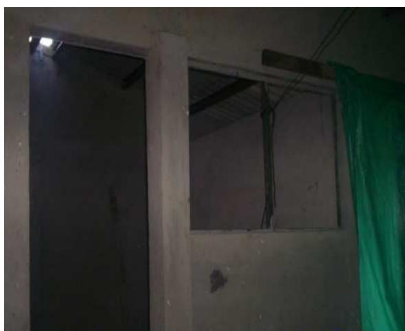
Figura 41. Estado actual del interior del Salón comunal Cuaspud Núcleo
