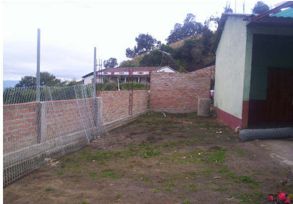
Figura 12. Ubicación del lugar donde se va a construir el restaurante escolar del Centro Educativo Antonio Nariño
