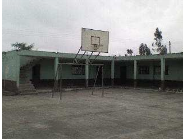
Figura 10. Evidencia de la necesidad de mampostería en el segundo piso del centro educativo San Marcos
