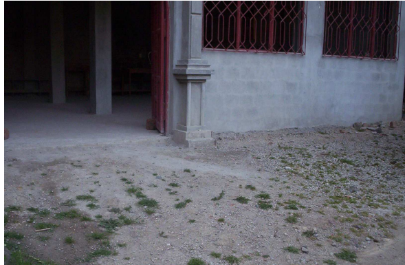
Figura 33. Estado actual de la entrada principal y del piso del salón comunal Frontales
