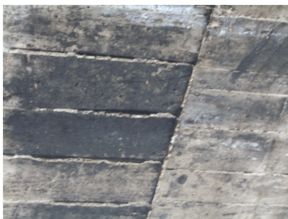
Figura 104. Evidencia de discontinuidad en el acabado inferior de la losa
