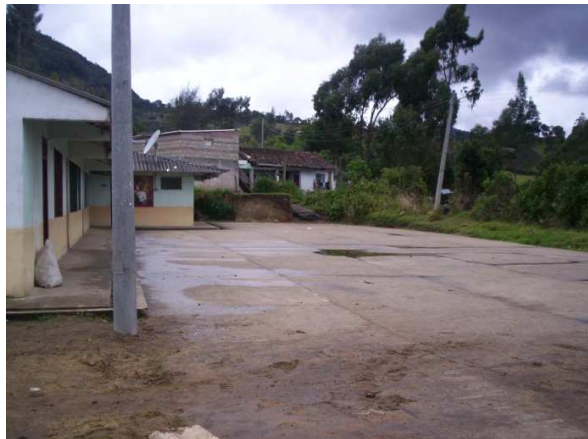
Figura 7. Evidencia del mal estado del piso del polideportivo y patio del Centro Educativo San Luis
