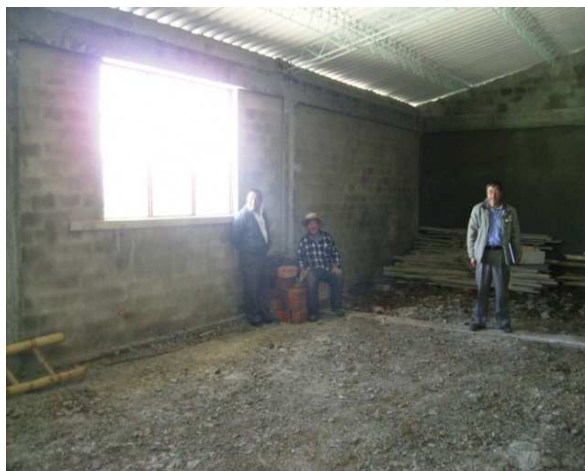
Figura 38. Estado actual del piso del salón comunal Cuaspud Cuatro Esquinas
