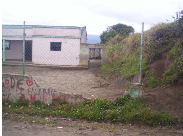
Figura 28. Estado del muro de cerramiento del centro educativo Yamuesquer
