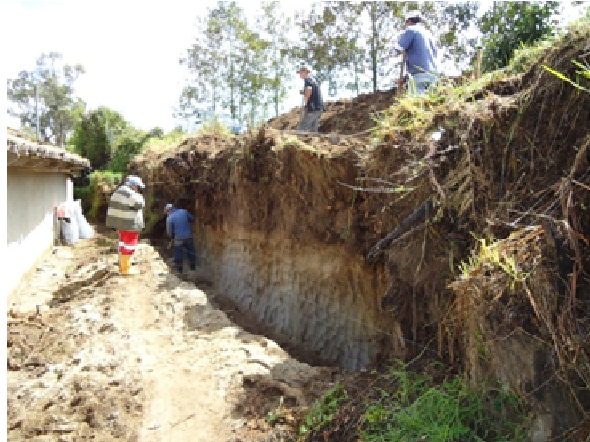
Figura 117. Localización y actividades de excavación para la construcción del muro de contención en gaviones
