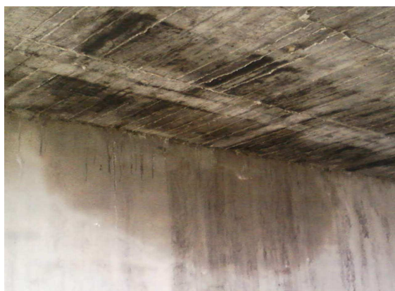
Figura 102. Presencia de humedad en muros y losa
