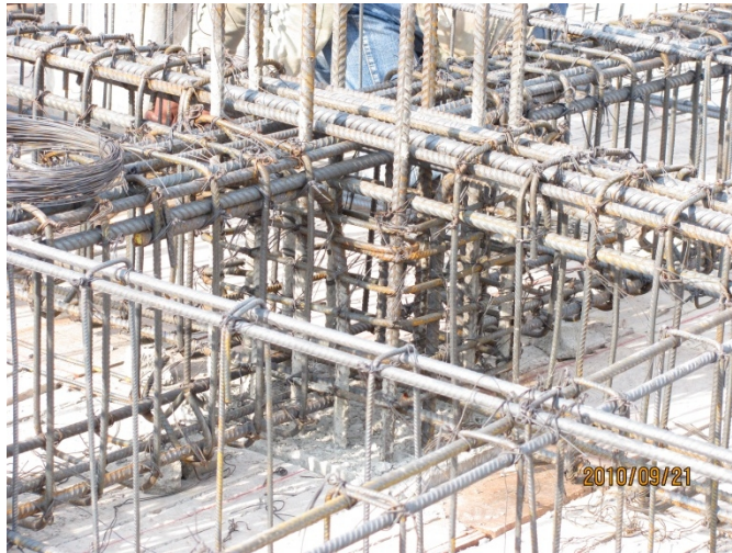
Figura 13 – Separación de flejes en cruce de columnas y vigas.
