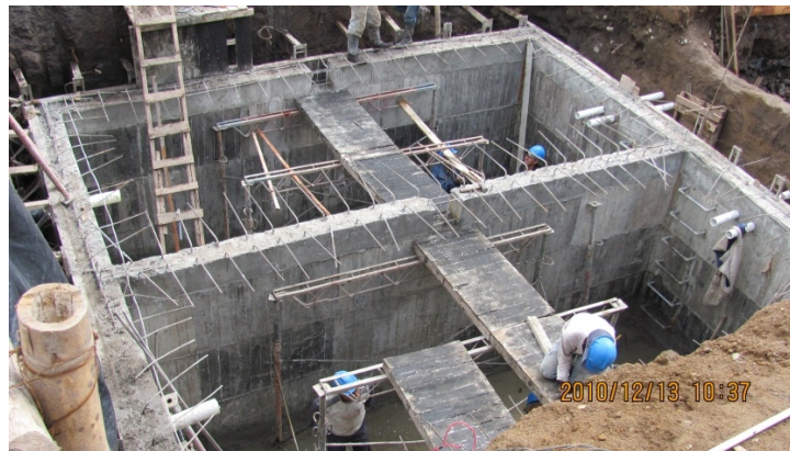
Figura 32 – Tanque recolector agua lluvias.
