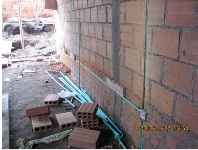
Figura 26 – Instalaciones eléctricas sobre muros.
