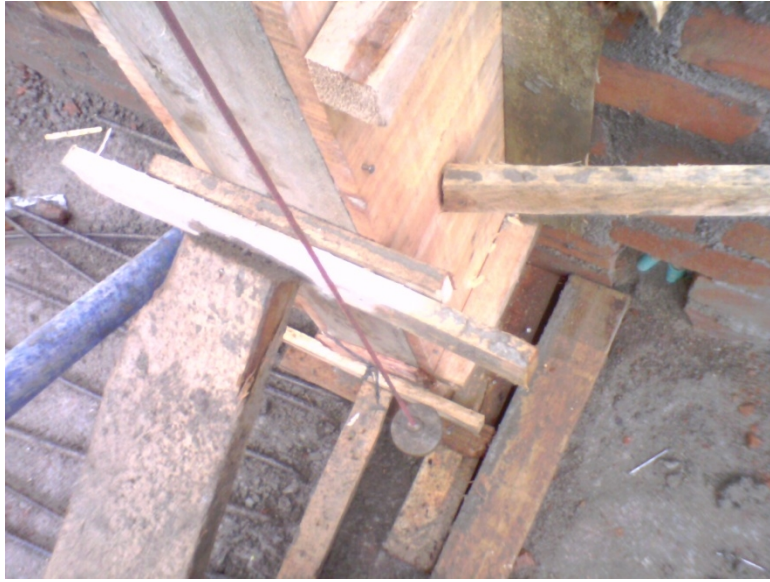
Figura 43. Plomo de tablero de columna
