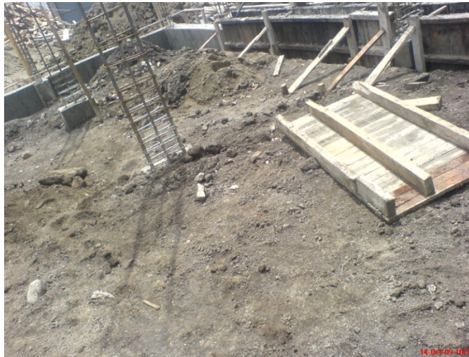
Figura 18. Desniveles en el terreno
