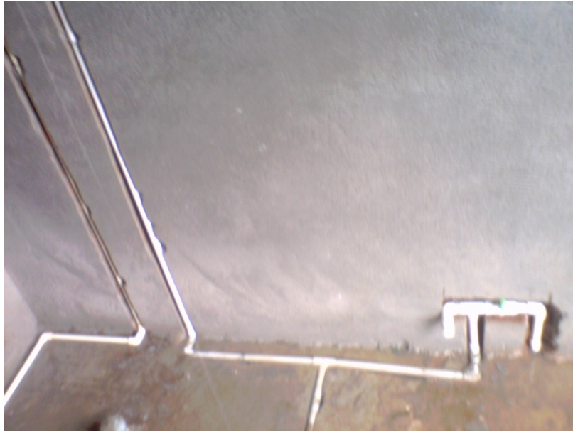
Figura 62. Redes hidráulicas internas tubería pvc y cpvc.
