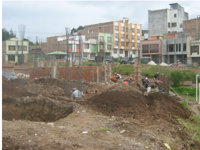
Figura 50. Vista del perfil de suelo e inicio de trabajos de cimentación y mampostería.
