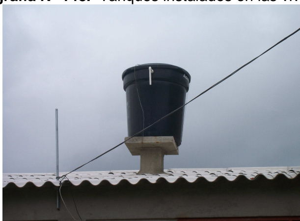
Fotografía N° 148. Tanques instalados en las viviendas
