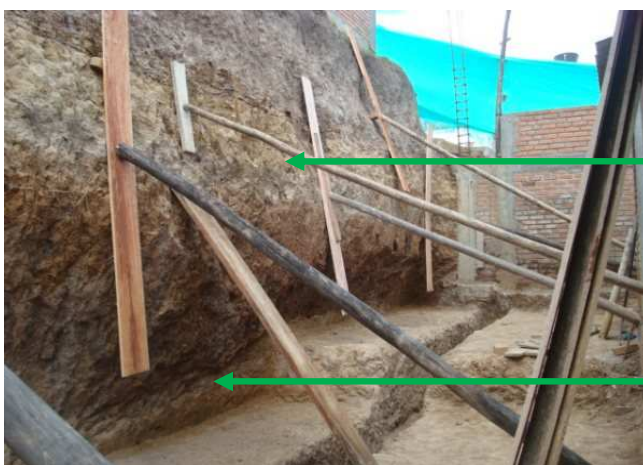
Fotografía N° 1 Desestabilización de talud
