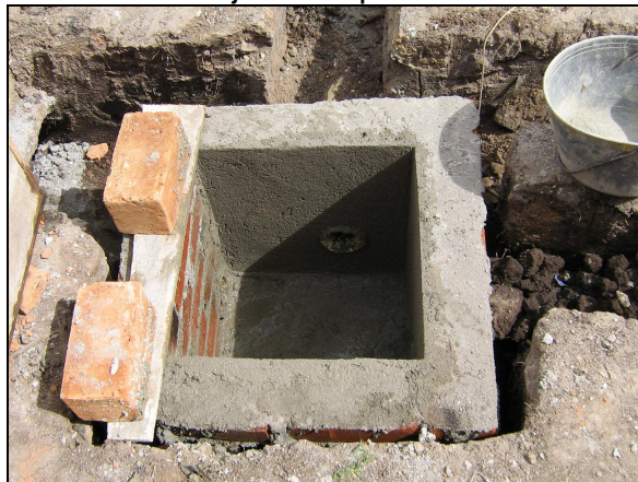
Fotografía N° 134. Caja de inspección de 50 cm. x 50 cm.
