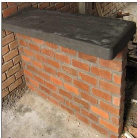
Fotografía N° 147. Mesón Auxiliar de Cocina
