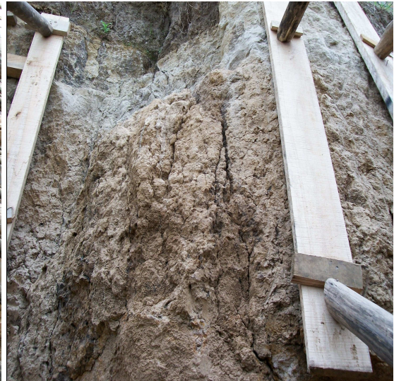
Fotografía N° 78 Líneas de falla en el talud
