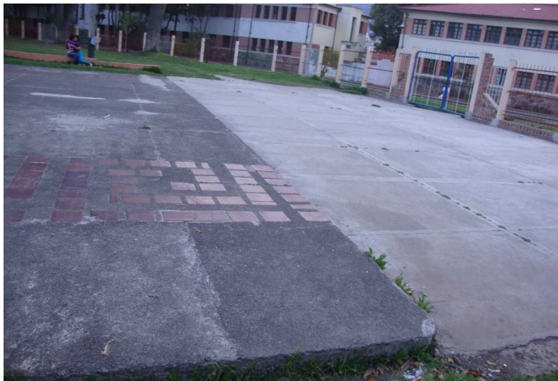
Figura 23. Vista reja donde se puede apreciar la distancia a la que ésta fue corrida hacia la vía
