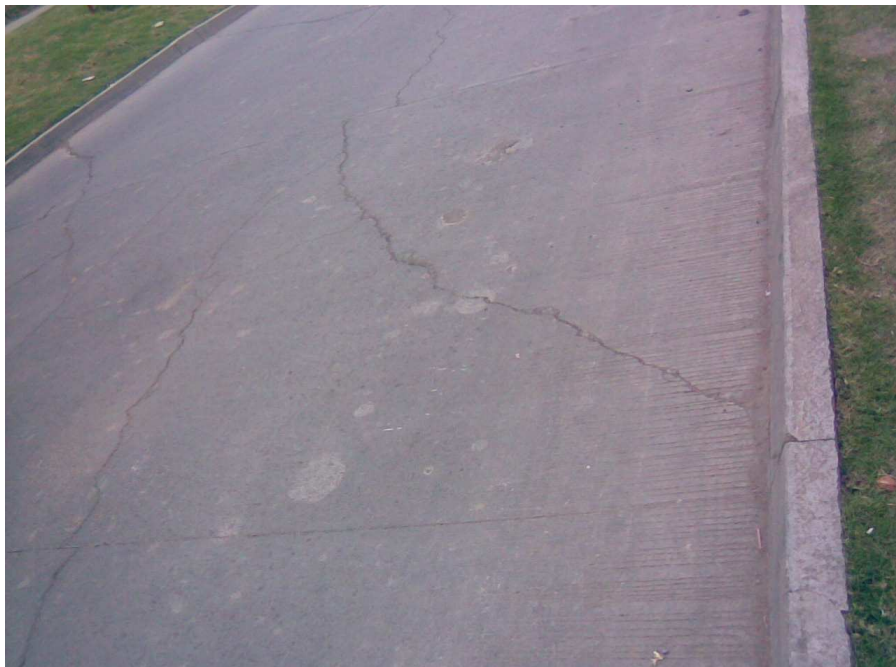
Figura 80. Pavimento colapsado por grietas en diversos paños
