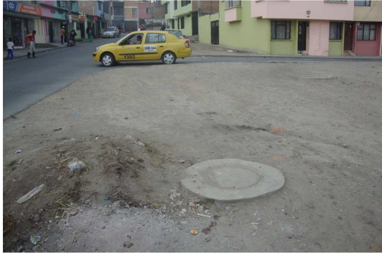
Figura 12. Cámara de inspección 2
