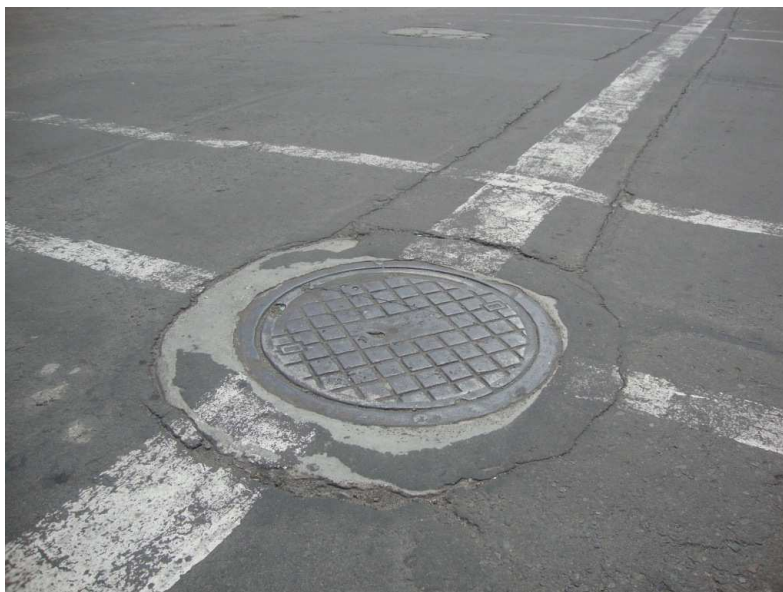
Figura 9. Cámara de inspección
