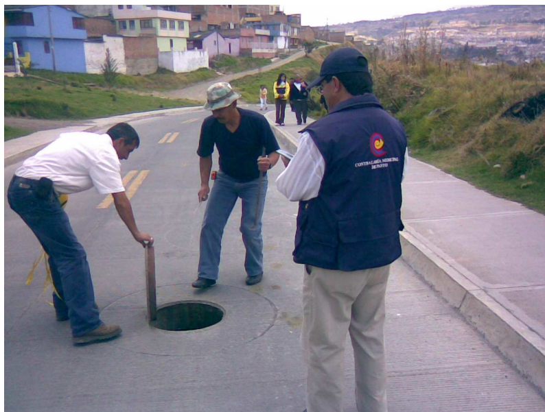
Figura 102. Otra cámara a la cual se verificó su conexión con los respectivos sumideros con tubería en AC de 10" de diámetro
