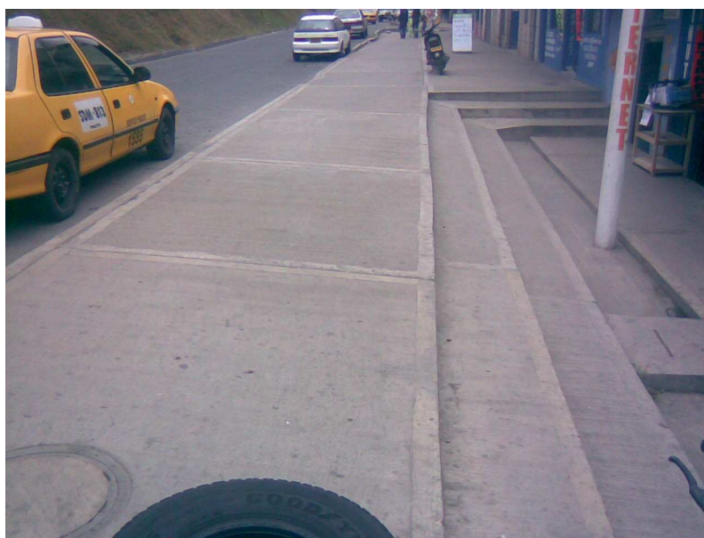
Figura 71. Andenes sobre la carrera 9 con desniveles a manera de escaleras
