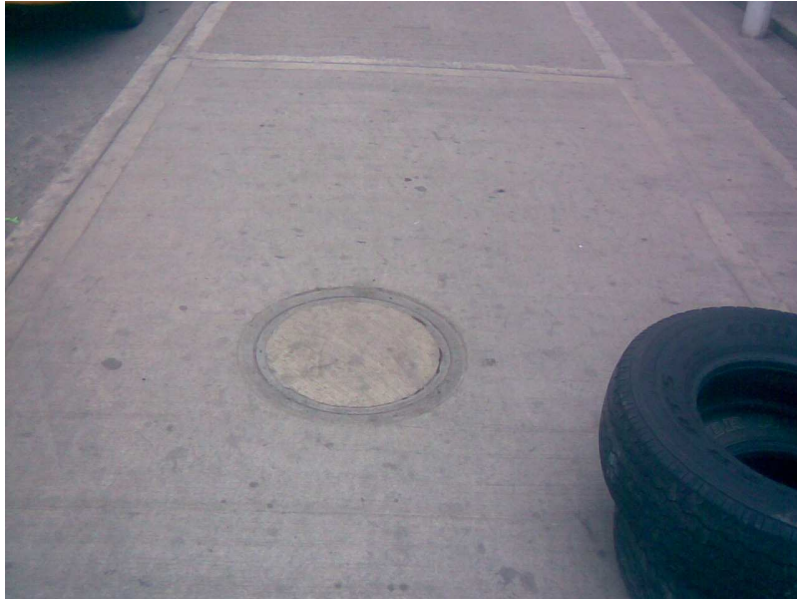
Figura 69. Cámara sanitaria 1 ubicada sobre el andén de la carrera 9
