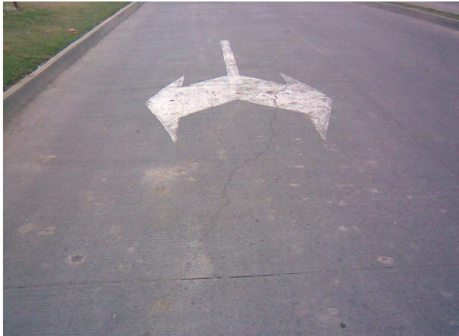
Figura 82. Grieta en otro paño del pavimento
