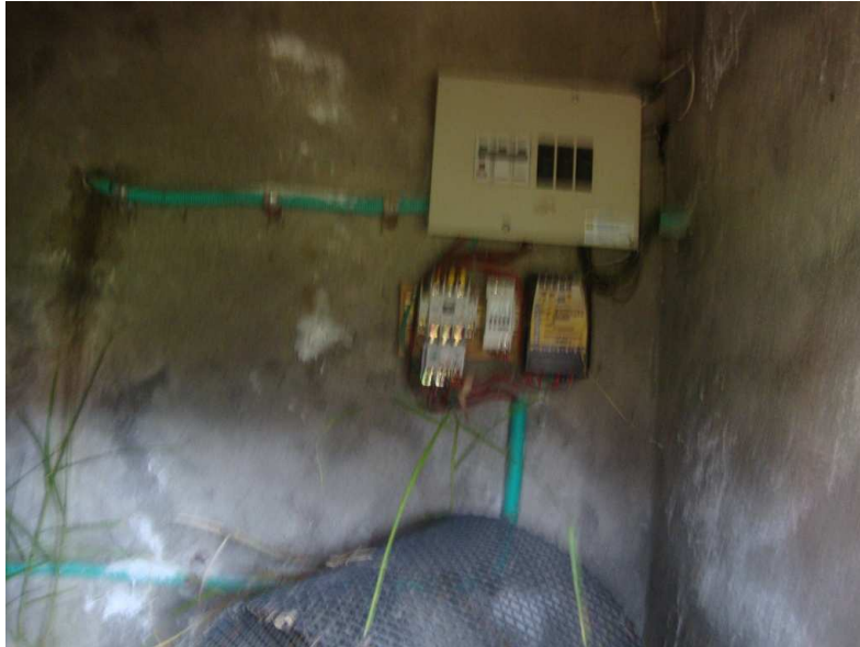
Figura 47. Vista general de brakers, y demás elementos constitutivos del sistema eléctrico de la fuente luminosa
