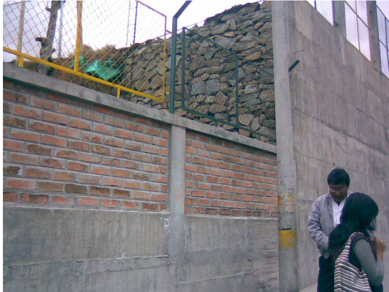
Figura 94. En el registro se observa el muro en gaviones que confina el relleno que técnicamente se debió realizar al lado izquierdo del muro en concreto reforzado
