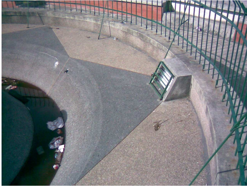
Figura 41. Estado de la fuente luminosa San Rafael
