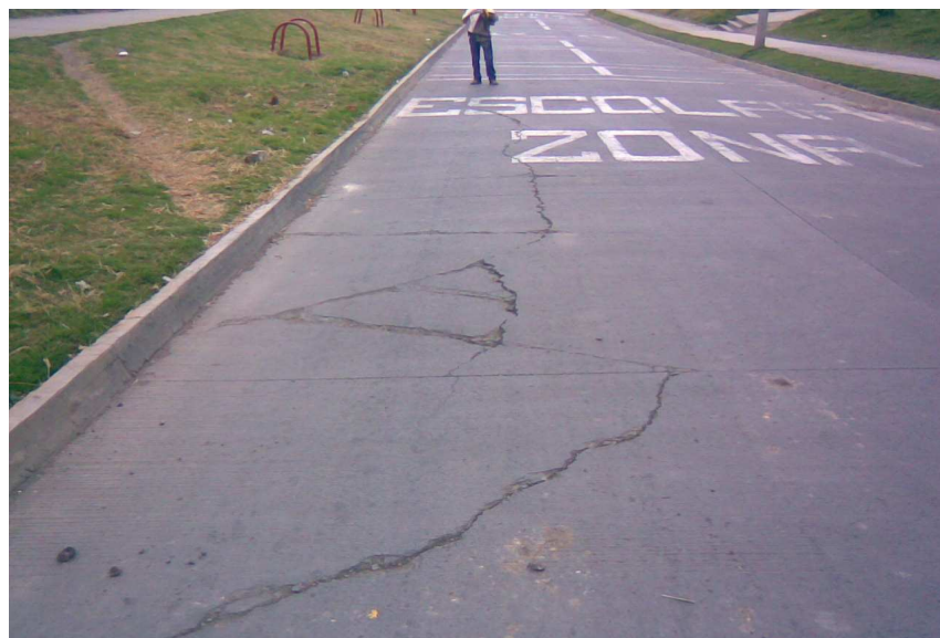
Figura 76. La misma grieta con su proyección a otros paños y su profundidad
