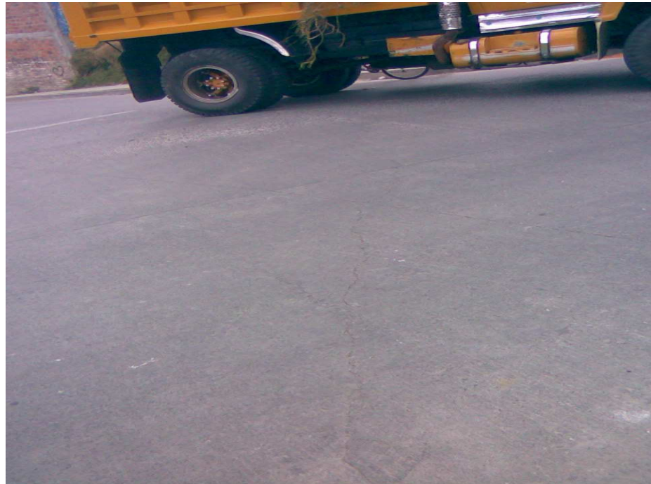
Figura 84. Esta vía soporta trafico pesado, lo que agrava el problema por que el pavimento se vera destruido en poco tiempo
