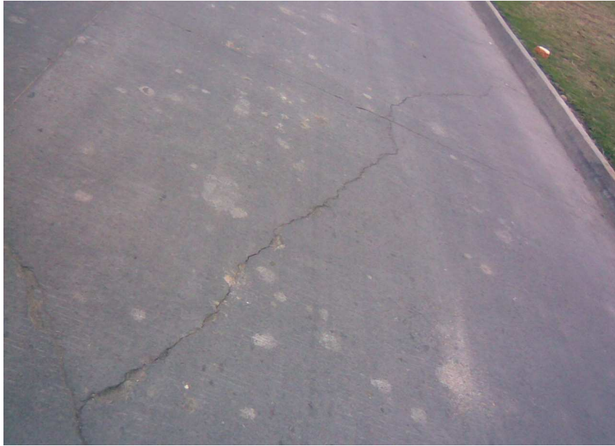
Figura 79. Otra grieta proyectada a otros paños y que bifurca en otras direcciones. Se observa además diferencias de nivel en el pavimento, lo cual se constituye en una prueba de asentamientos
