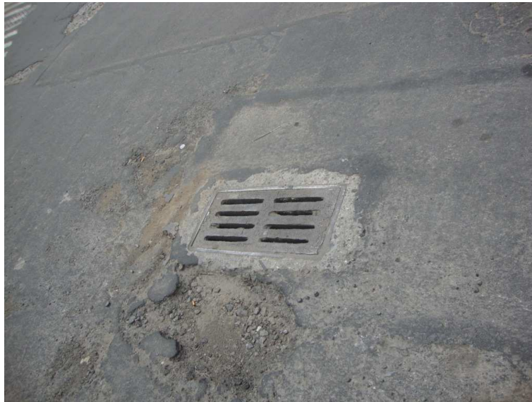
Figura 8. Sumidero mal ubicado que difícilmente puede cumplir con la función para la que fue diseñado
