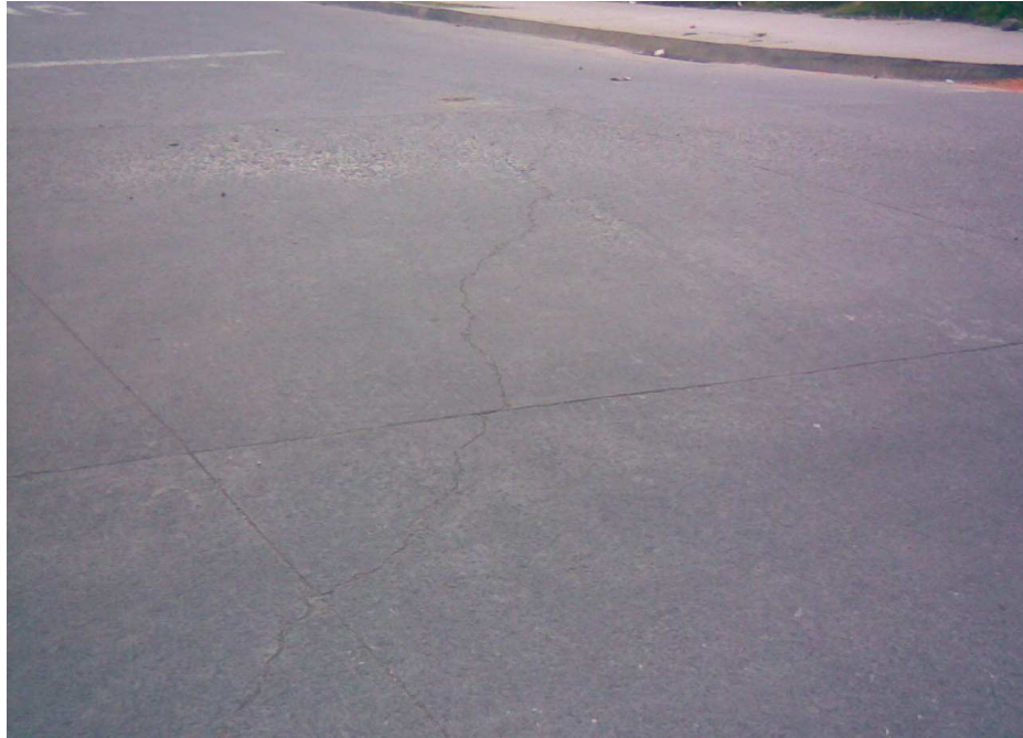
Figura 83. Grietas en varios paños, se puede observar además desgaste del pavimento
