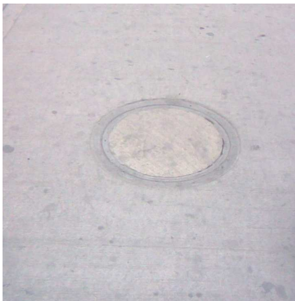
Figura 70. Cámara sanitaria 2 ubicada sobre el andén de la carrera 9
