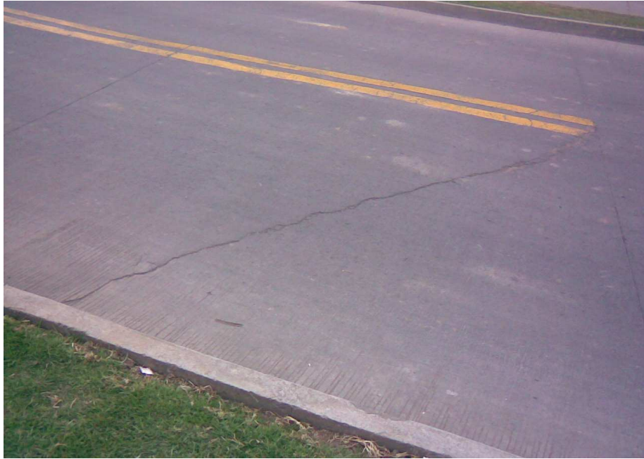
Figura 77. Grieta en otra abscisa, se mira su proyección a otros paños
