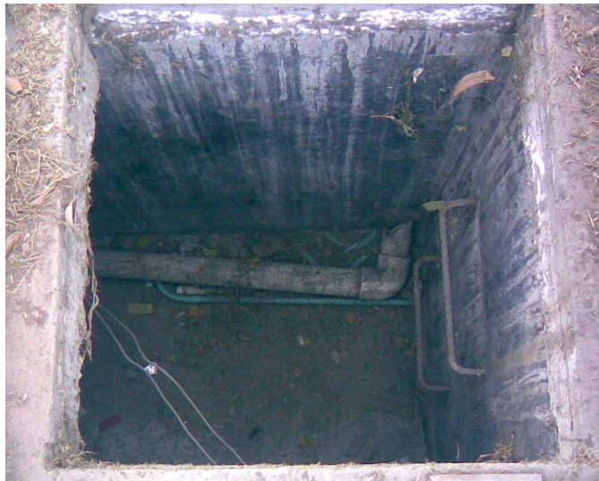
Figura 49. Sitio de instalación de motobomba ausente en momento de la visita
