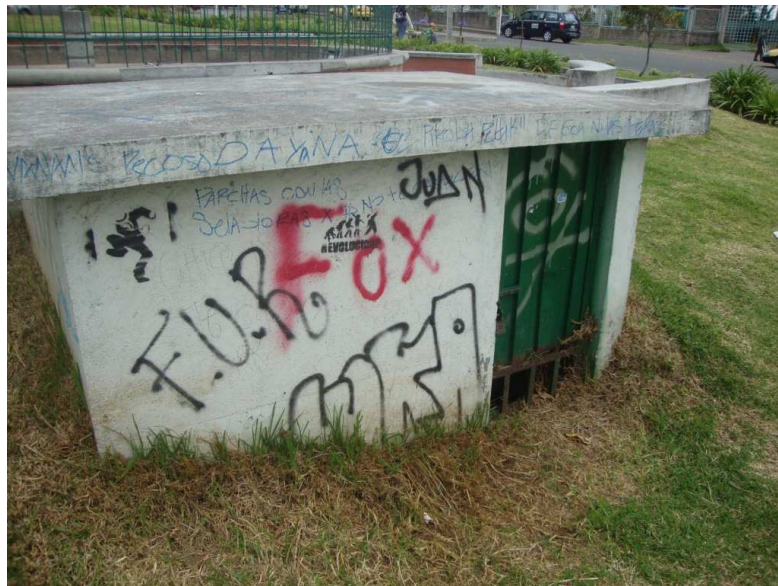
Figura 46. Caseta contenedora de elementos eléctricos proveedores y controladores de iluminación de fuente luminosa
