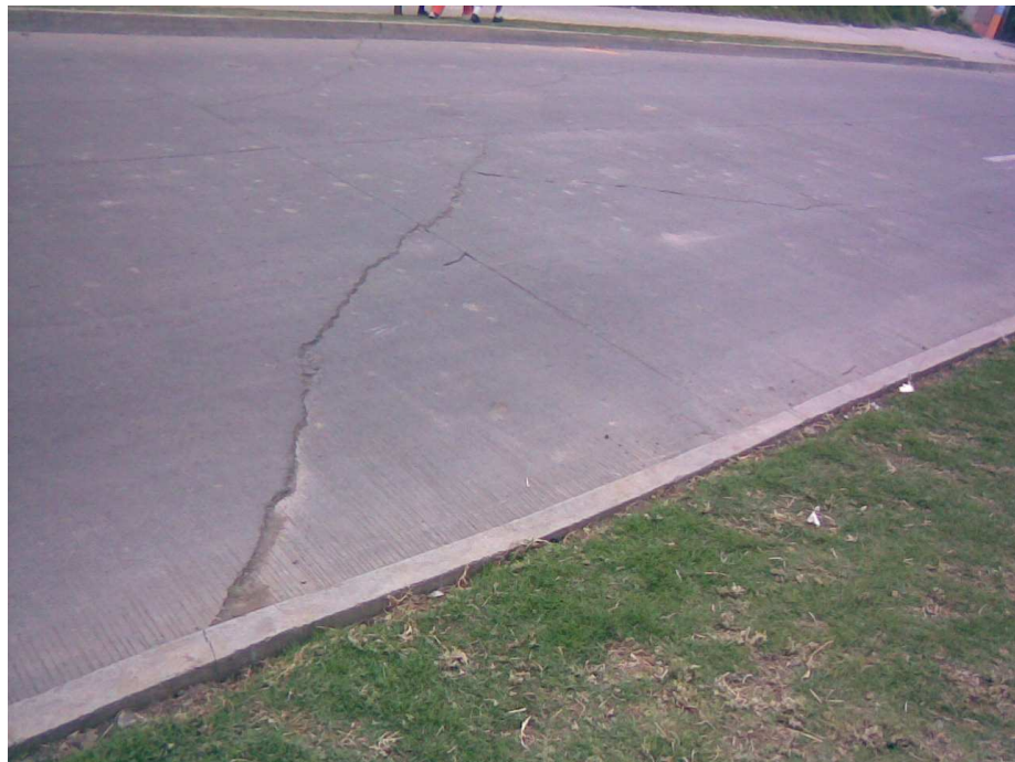
Figura 78. Otra grieta en el pavimento, aquí ya se puede observar la base
