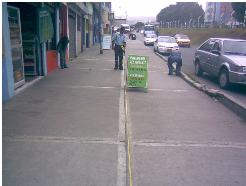
Figura 66. Andenes sobre la carrera 9. Podemos observar el deterioro del sardinel porque los usuarios utilizan dicho andén como parqueadero
