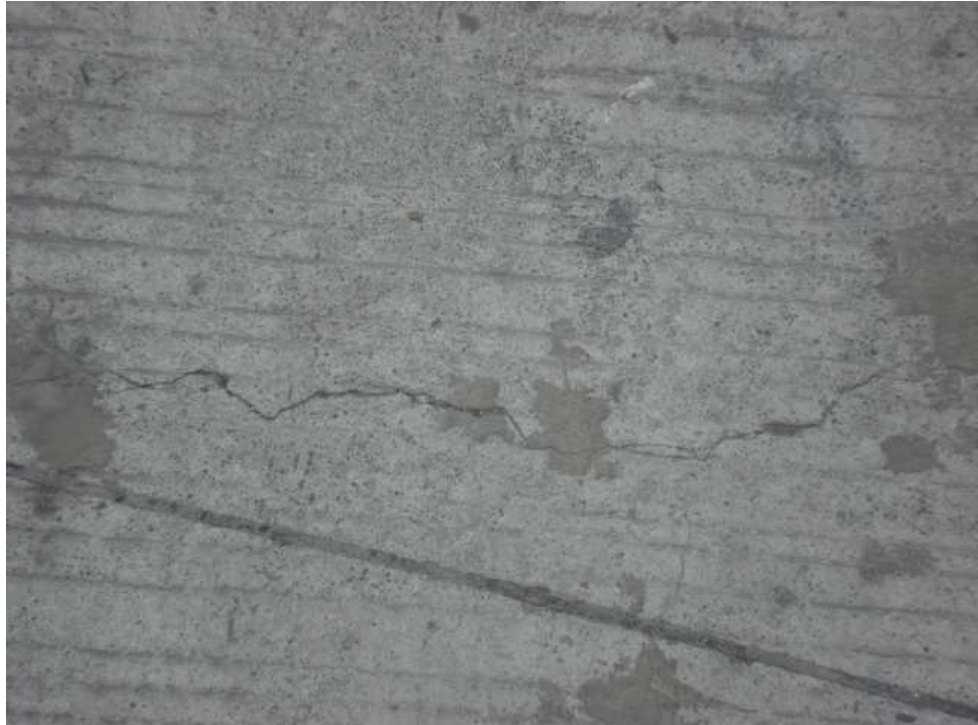
Figura 111. Una de las grietas transversales presentes en los paños
