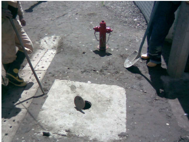
Figura 1. Inspección caja para válvula de hidrante con tapa en concreto y tapavalvula tipo chorote
