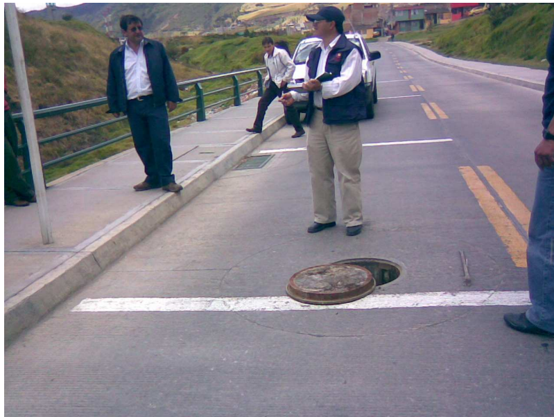
Figura 101. Cámaras a las cuales se verificó su respectiva altura desde cota de cañuela hasta cota del terreno. Se verificó también el esmaltado, su forma y tuberías de entrada y salida
