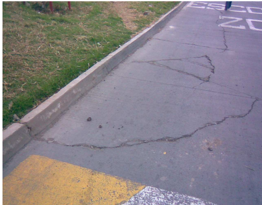
Figura 75. Grieta en la que se puede observar inclusive la falla de la estructura del pavimento y los asentamientos de la estructura
