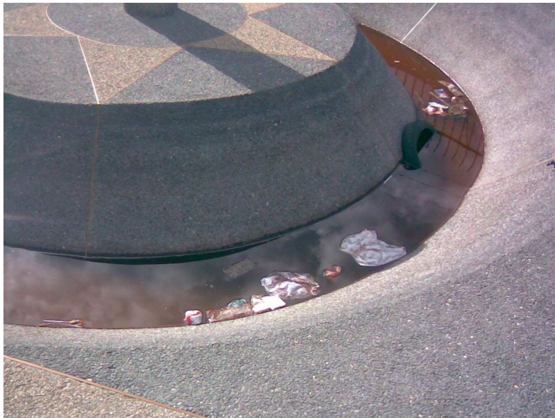
Figura 42. Falta de mantenimiento y limpieza de la fuente luminosa San Rafael
