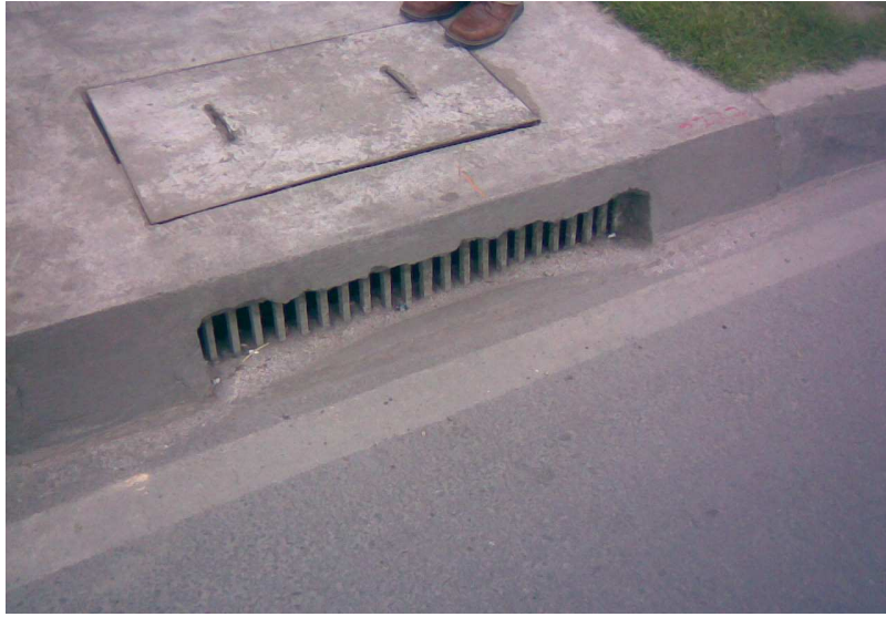
Figura 58. Muestra de una de las rejillas horizontales que reciben las aguas lluvias de las dos vías
