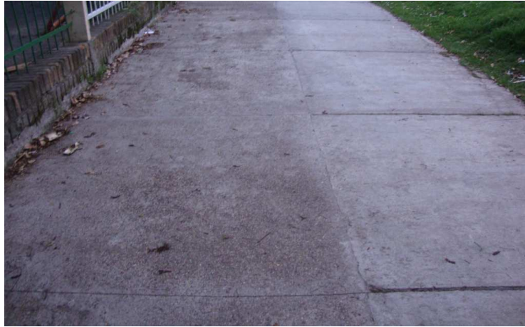
Figura 32. Vista del deterioro del andén en granito lavado
