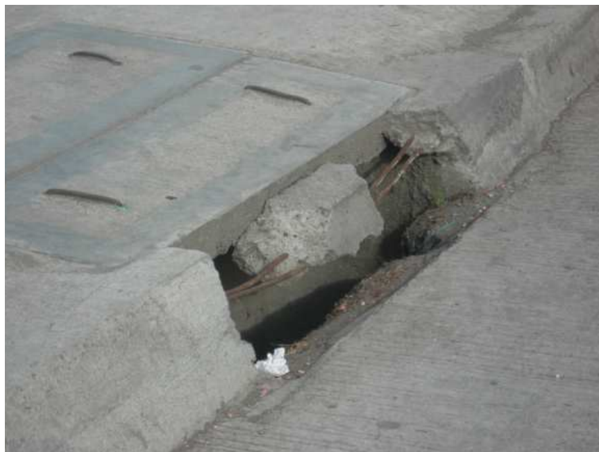
Figura 110. Sumidero lateral destruido
