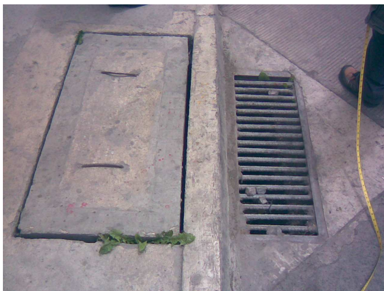
Figura 68. Sumidero construido en un área de la vía
