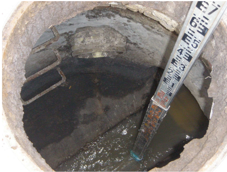
Figura 109. Medición de cámaras de inspección del alcantarillado pluvial y sanitario donde se aprecia el descuido de interventoría
