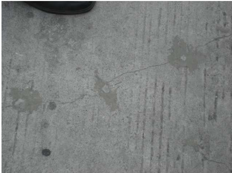
Figura 112. Grieta curada deficientemente con Sikalatex
