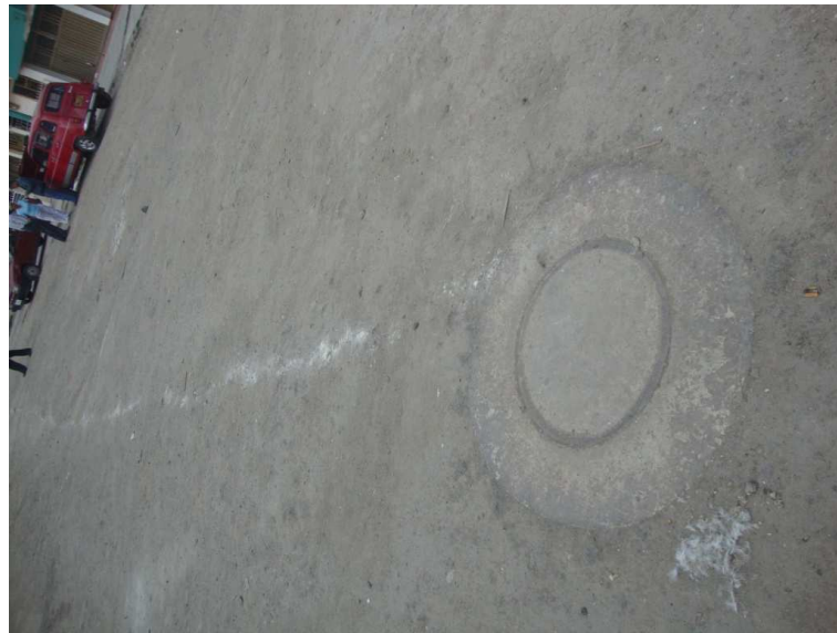
Figura 13. Cámara de inspección 3
