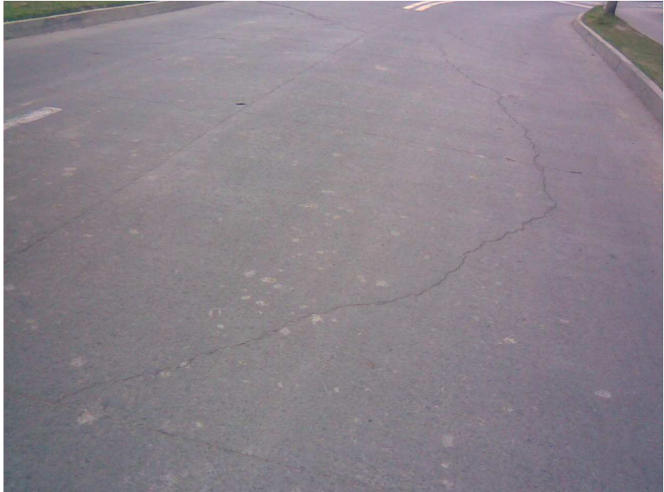
Figura 81. Grieta proyectada a varios paños, inclusive se mira diferencias de nivel en el pavimento
