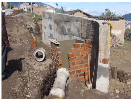
Figura 99. Sumidero esmaltado y con conexión de tubería
