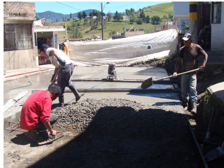
Figura 83. Extensión del concreto
