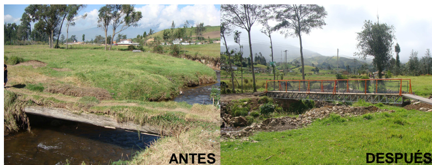
Figura 40. Estados del puente corregimiento de San Fernando, vereda La Playita municipio de Pasto.
