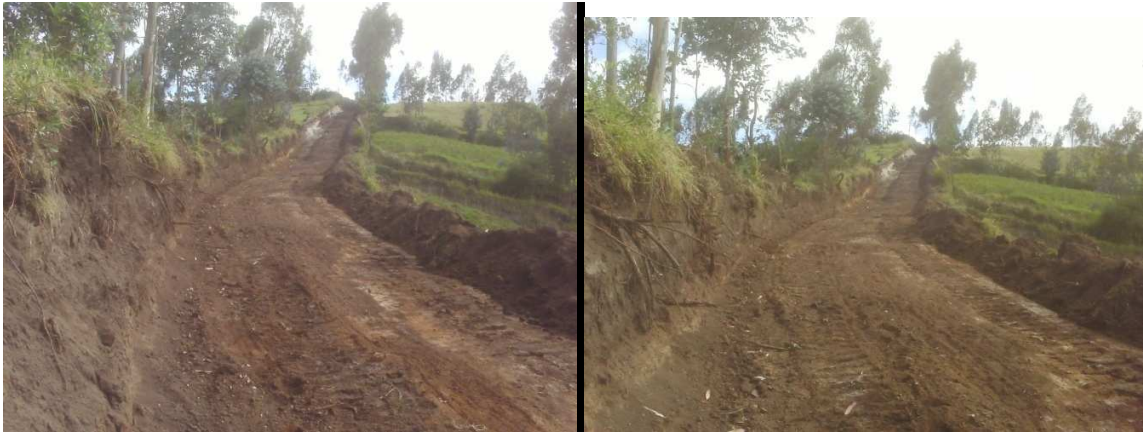
Figura 46. Apertura de la vía que conduce de la vereda Cutuaquer a la vía Ipiales-La Victoria tramo III.
