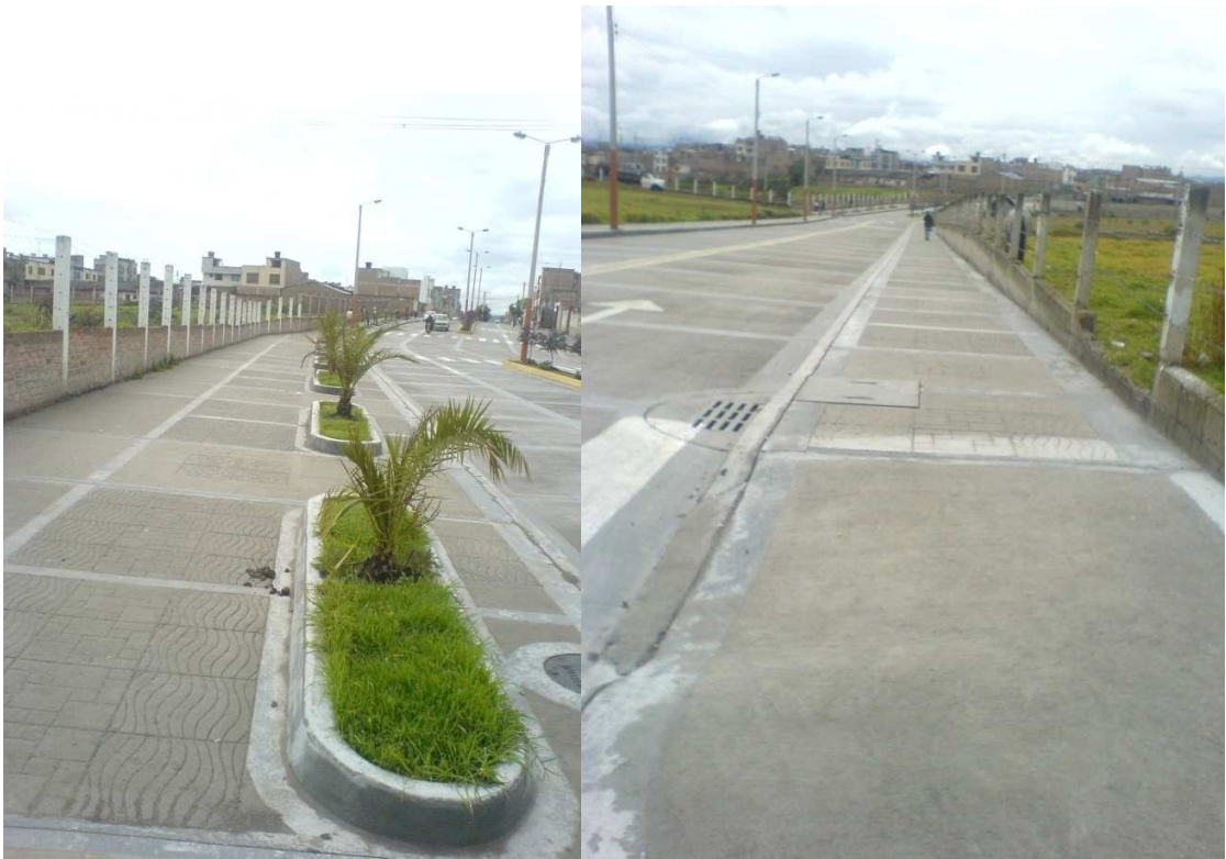
Figura 10. Estado actual de los andenes, cra. 5ª.
