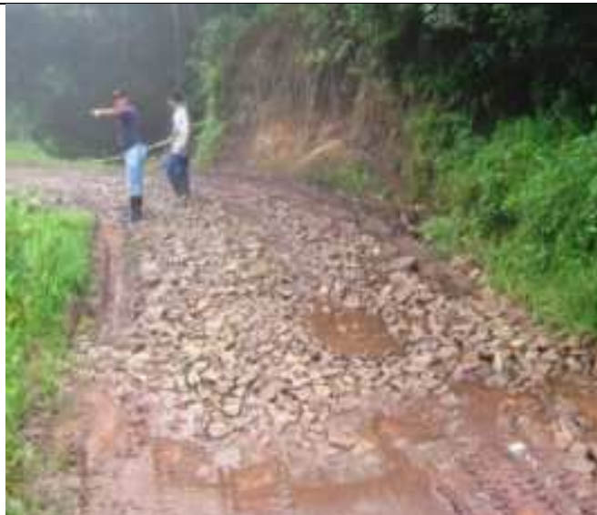
Fotografía N° 21: PR 0+0550, N1 30.922 W77 07.786, gran presencia de agua en la banca, baches de gran tamaño.
