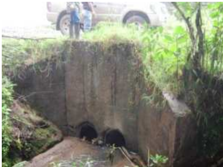
Fotografía N° 23: K0+0100 salida de alcantarilla gemela de diam 24", falta de mantenimiento, N1 30.694 W77 07.770
