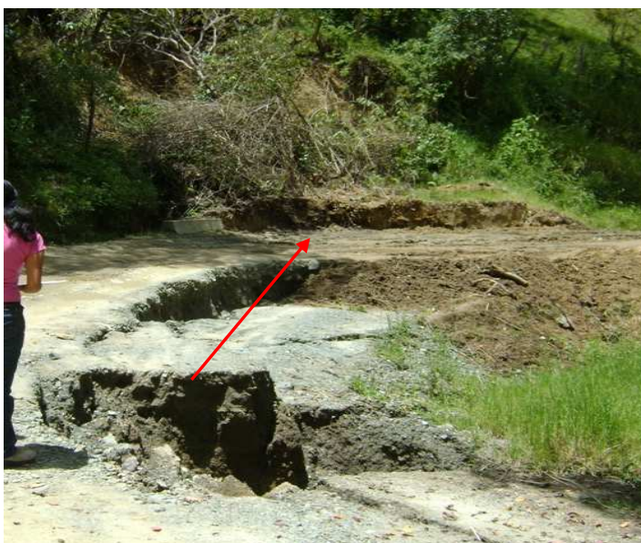
Fotografía N° 90: K6+0900, perdida de banca, N1 32.276 W77 03.984, se necesita estabilizar la banca.
