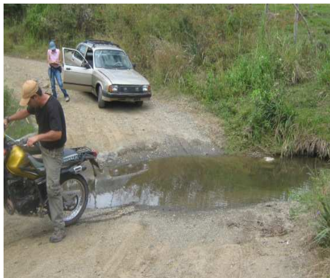
Fotografía N° 69: K8+0100, agua atraviesa la banca se necesita la construcción de una alcantarilla o pontón, N1 39.181 W77 10.085
