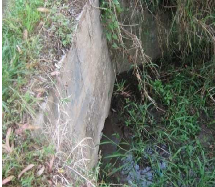
Fotografía N° 41: K2+0100, N1 35.324 W77 07.282 Gemelas, falta de mantenimiento.
