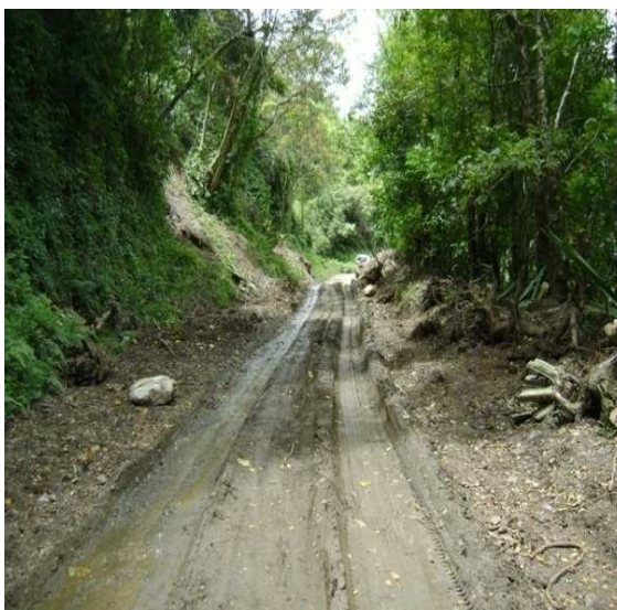
Fotografía N° 80: K7+0200, N1 32.311 W77 03.890, presencia de agua en la banca, vegetación descontrolada, cunetas tapadas.
