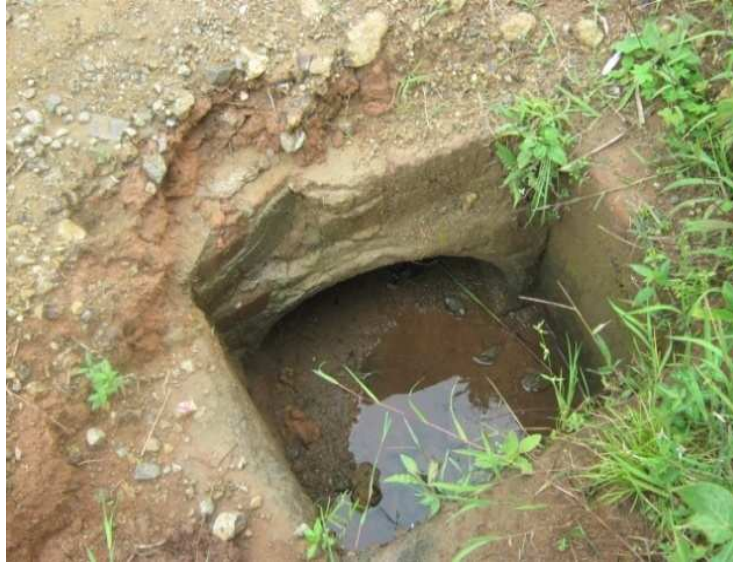
Fotografía N° 57: K0+0250, Caja de entrada en ladrillo, se debe reconstruir, N1 36.749 W77 07.676
