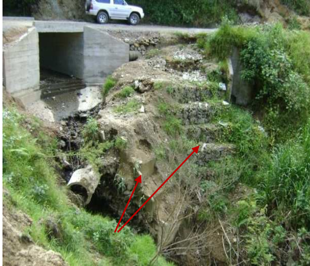
Fotografía N° 91: K7+0300, al construir el pontón se destruyó un muro de contención en gaviones y el aliviadero, N1 32.292 W77 03.845.
