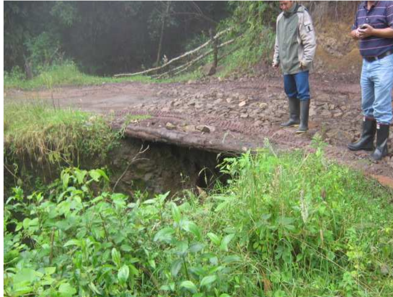
Fotografía N° 25: K0+0600 Pontón en madera se requiere construcción del pontón en concreto reforzado. N1 30.922 W77 07.786
