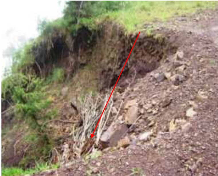
Fotografía N° 26: K4+0600, pérdida de banca se requiere la construcción de un muro de contención, N1 31.551 W77 08.705
