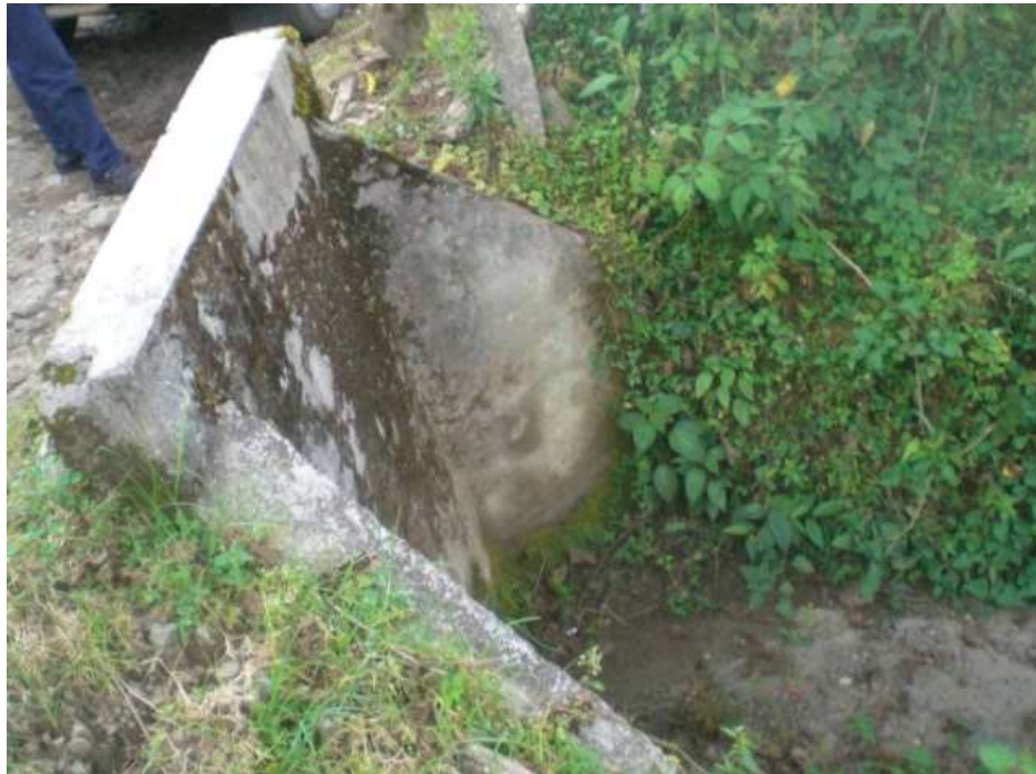
FOTOGRAFIA N° 96: Salida de alcantarilla
