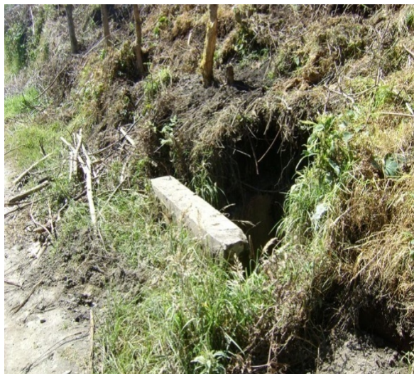
Fotografía N° 75: K2+0650, caja de entrada de alcantarilla, falta de mantenimiento, N1 31.122 W77 06.406.
