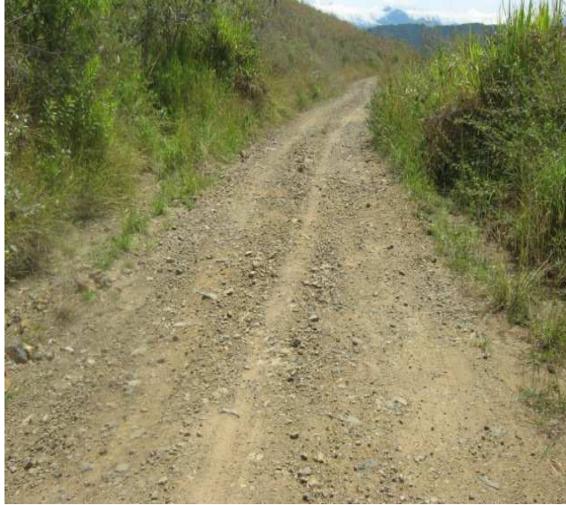
Fotografía N° 64: K10+0600, N1 39.523 W77 11.646, vegetación descontrolada
