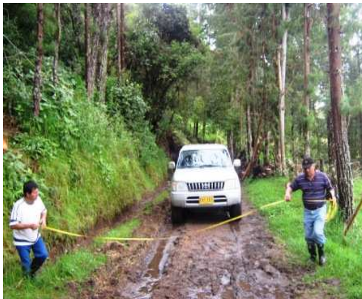
Fotografía N° 27: K7+0000, se requiere la construcción de una alcantarilla por presencia de agua en la banca, N1 31.950 W77 09.526
