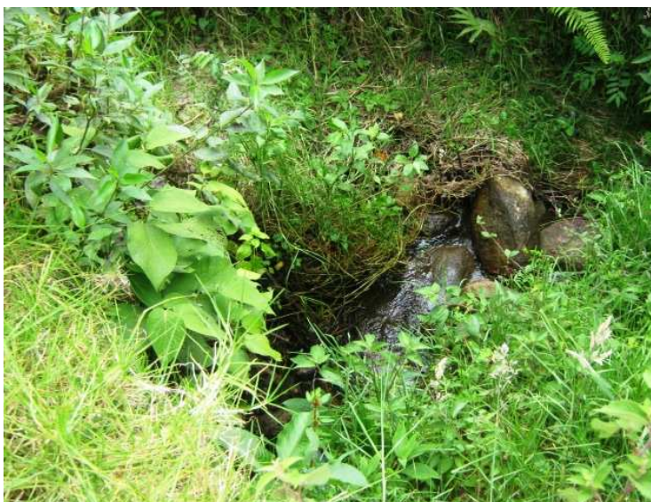
Fotografía N° 18: K3+0100, alcantarilla en piedra se necesita la construcción de una en concreto, N1 30.610 W77 07.448
