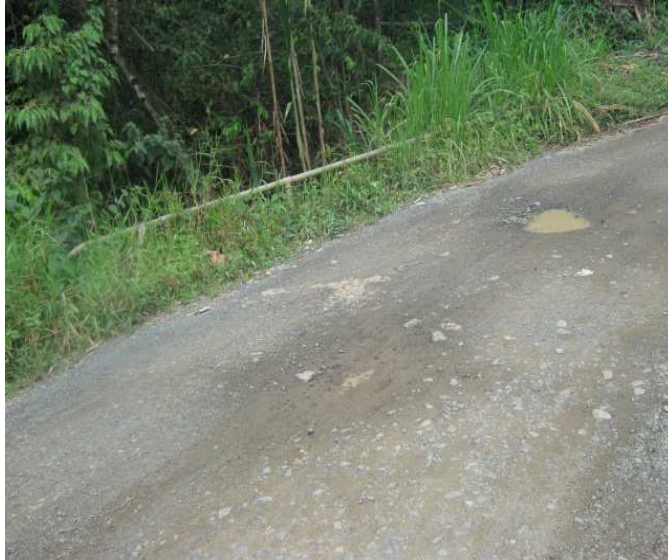
Fotografía N° 39: K6+0300, N1 35.640 W77 06.343 falta de mantenimiento a la vía, presencia de agua en la banca que han ocasionado baches e irregularidades.
