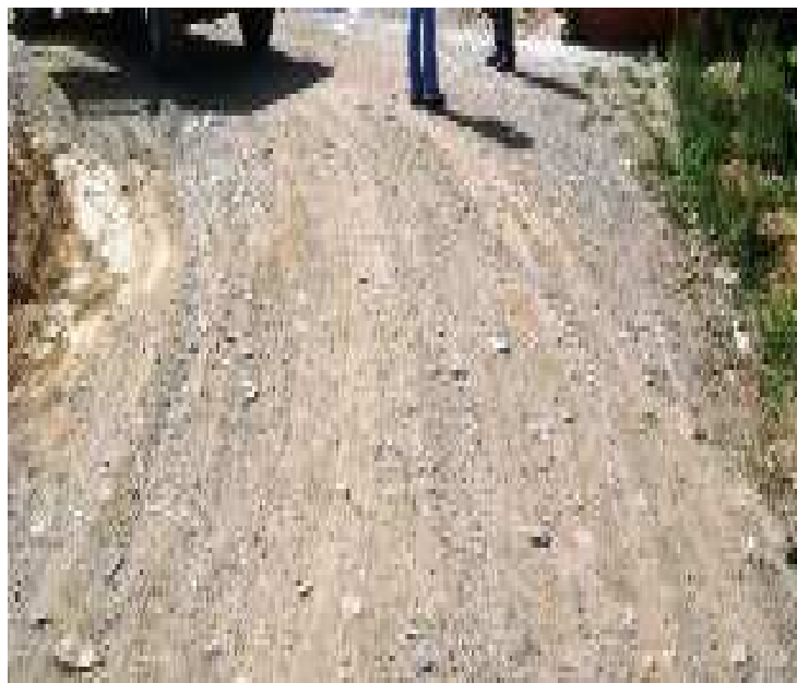
Fotografía N° 7: K3+0500, N1 29.574 W77 09.595, presencia de material suelto.
