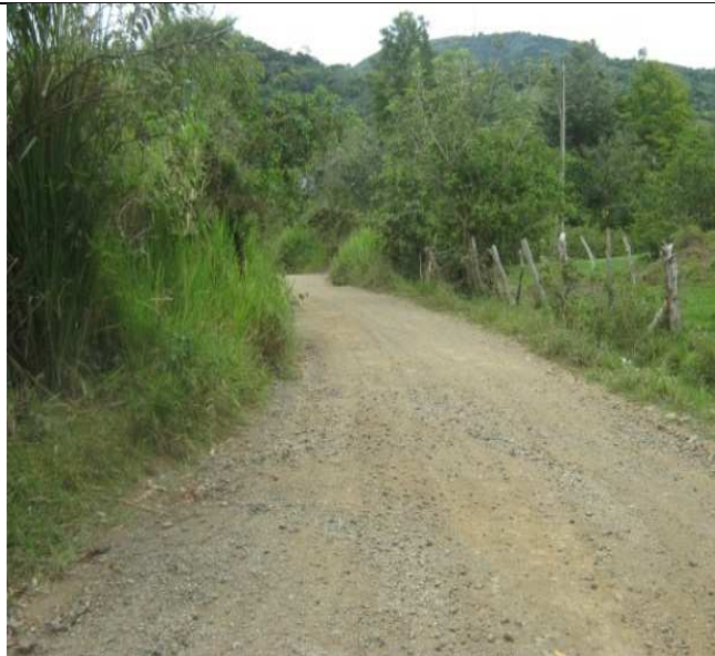
Fotografía N° 48: K0+0500, N1 38.150 W77 09.337, vegetación descontrolada cunetas tapadas.
