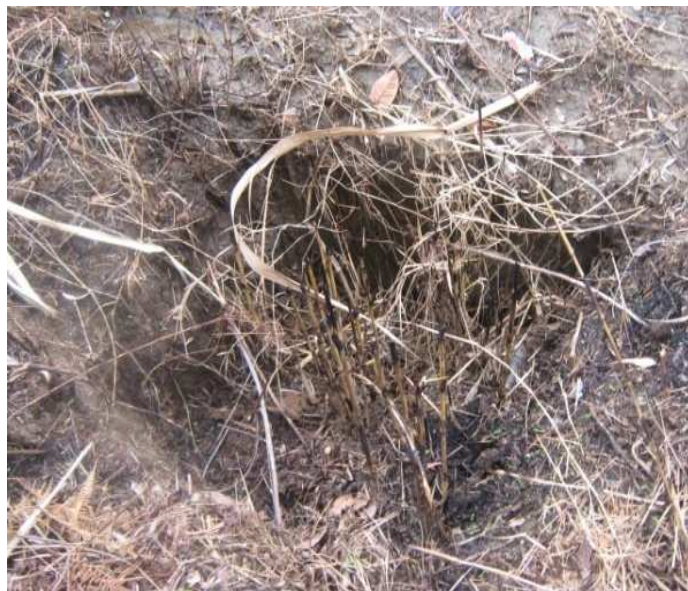
Fotografía N° 42: K2+0300, N1 35.256 W77 07.244 Alcantarilla colmatada.
