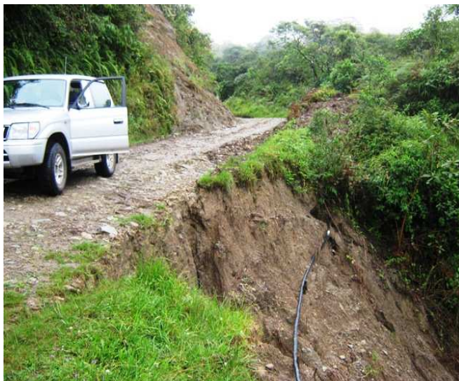
Fotografía N° 35: K5+0900, Es necesario la construcción de un muro de contención, debido a la pérdida de banca, N1 33.605 W77 08.382.
