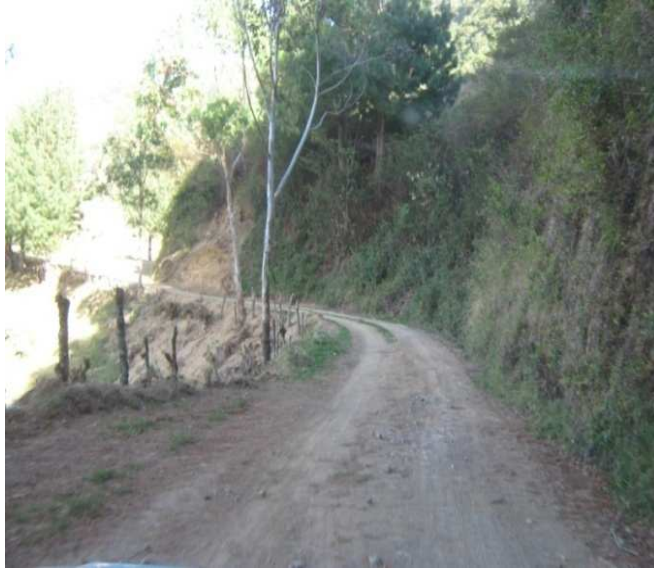
Fotografía N° 55: K3+0000, N1 37.607 W77 07.035, vegetación descontrolada, presencia de baches.
