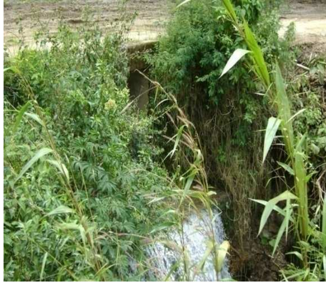
Fotografía N° 85: K6+0400, box culvert, falta de mantenimiento, N1 32.394 W77 04.252
