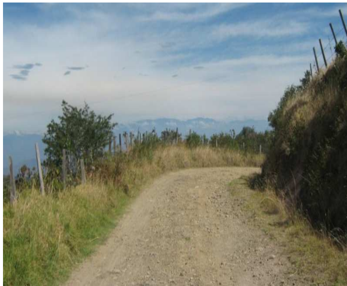
Fotografía N° 31: K6+0200, N1 34.043 W77 08.160, cunetas tapadas, la vía presenta baches.
