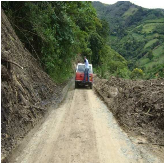
Fotografía N° 79: K5+0000, N1 32.262 W77 04.659, no se ha retirado el derrumbe las obras de arte están tapadas.
