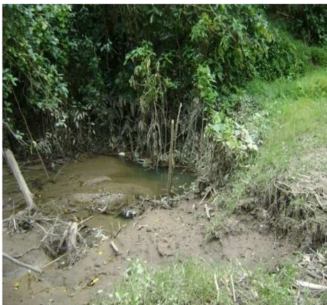
Fotografía N° 88: K6+0250, caja de entrada de Box culvert, se debe limpiar, N1 32.323 W77 04.344
