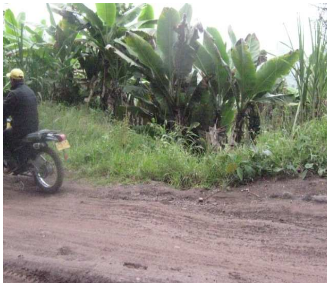
Fotografía N° 40: K6+0600, N1 35.779 W77 06.341 se encuentran baches de gran tamaño.
