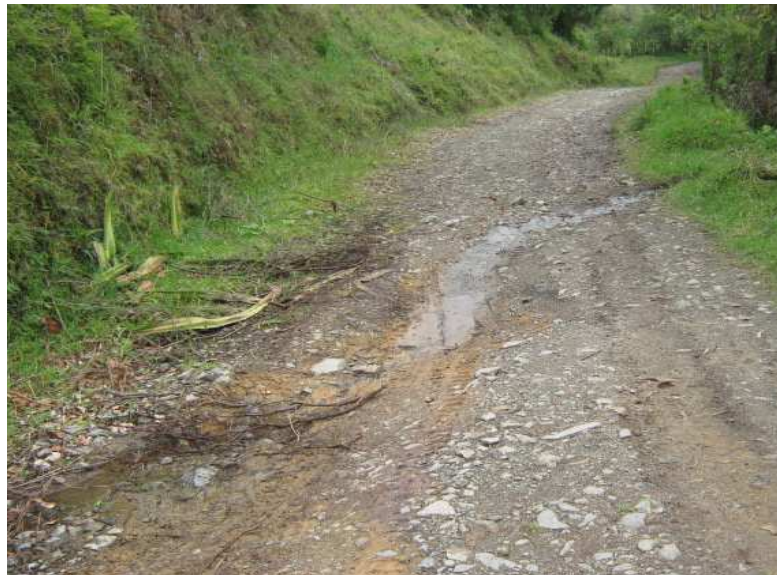
Fotografía N° 26: K1+0450, se requiere la construcción de una alcantarilla por presencia de agua en la banca, N1 31.237 W77 07.914
