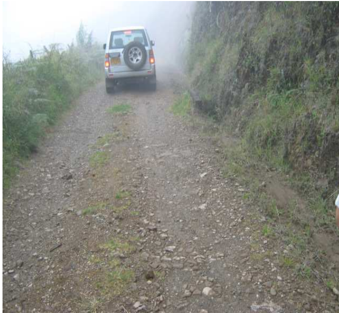
Fotografía N° 30: K2+0900, N1 33.048 W77 08.520, material suelto, cunetas tapadas, falta de afirmado.
