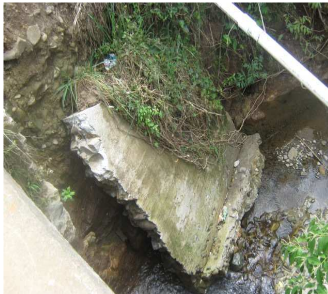
Fotografía N° 68: K1+0750, aleta de pontón destruida, N1 38.000 W77 09.467
