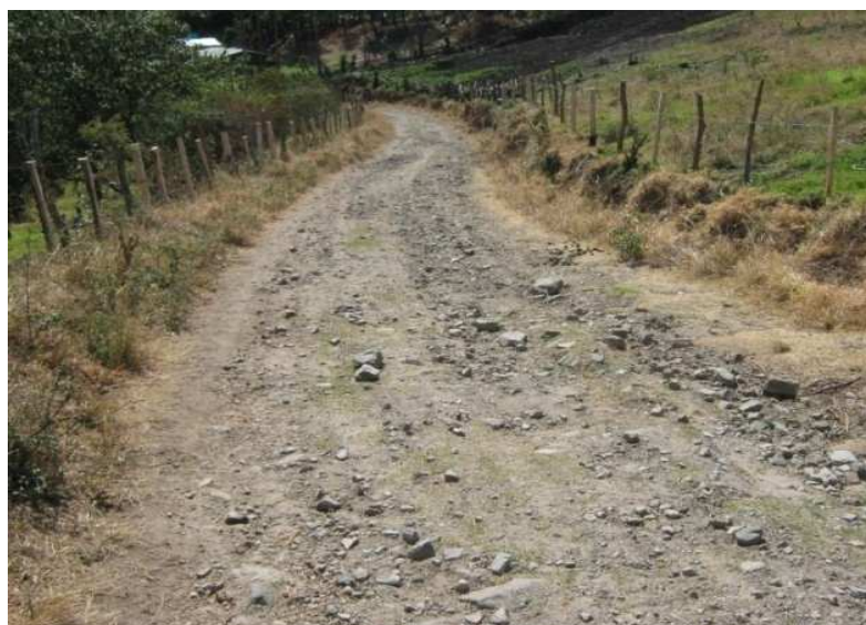
Fotografía N° 16: K4+0100, N1 30.772 W77 07.115, presencia de material suelto, baches de gran tamaño.
