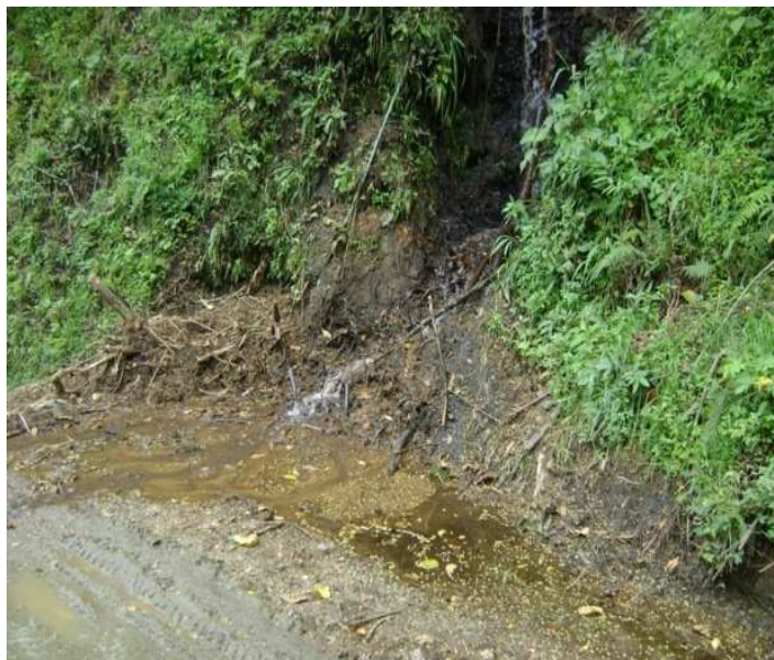
Fotografía N° 89: K6+0700, alcantarilla colmatada se necesita la construcción de una nueva, presencia de agua en la banca, N1 32.276 W77 04.210.
