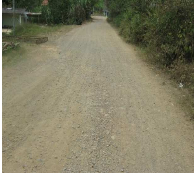
Fotografía N° 47: K0+0100, N1 37.983 W77 09.471, presencia de material suelto, deformaciones en la banca.
