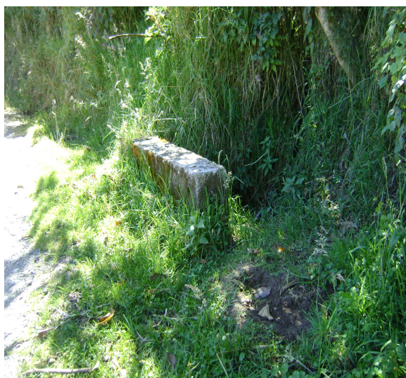
Fotografía N° 76: K4+0250, Cabezote de alcantarilla sin mantenimiento, N1 30.798 W77 07.044.
