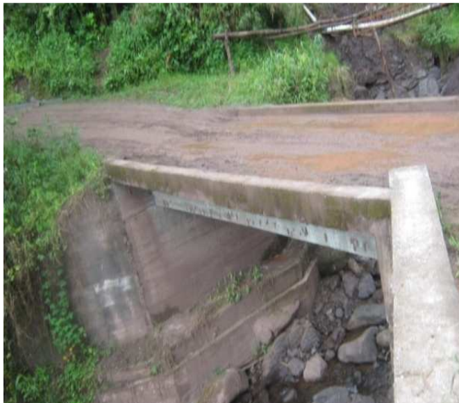
Fotografía N° 43: K6+0600, N1 35.544 W77 06.318 Pontón, se debe descargar.
