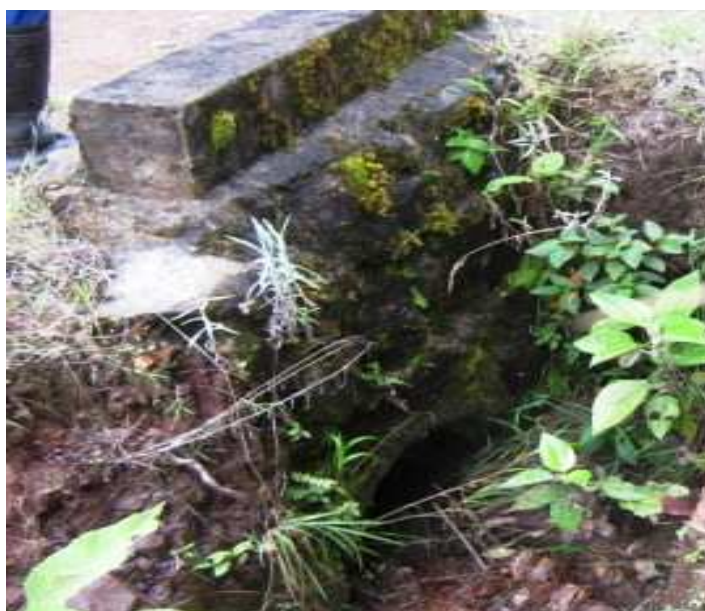
Fotografía N° 24: K1+0700, Caja de entrada de alcantarilla, semi-tapada, sin mantenimiento, N1 31.344 W77 07.918
