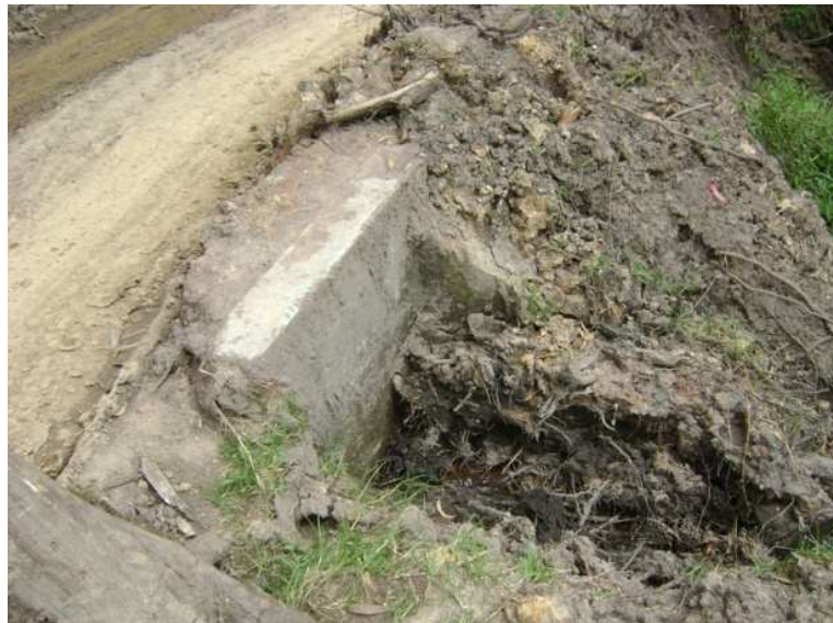
Fotografía N° 82: K2+0300, Caja de salida tapada, N1 31.624 W77 05.097
