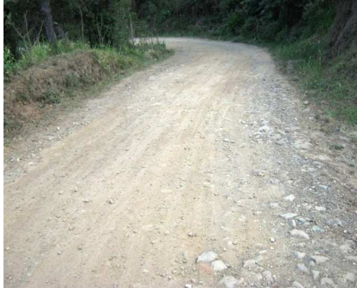
Fotografía N° 6 K0+0300, N1 29.196 W77 08.677, presencia de baches y deformaciones en la vía y material suelto.
