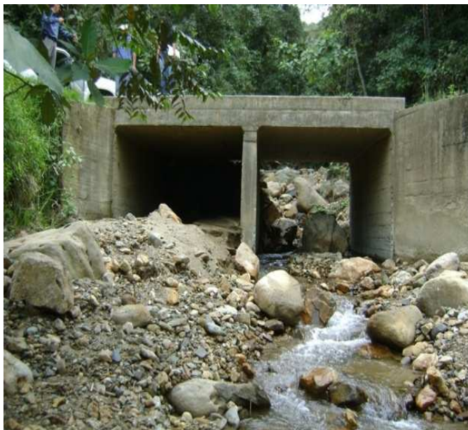
Fotografía N° 93: K8+0500, pontón en mal estado por creciente, se necesita destapar o construcción de un nuevo pontón sin el tabique, N1 32.359 W77 03.465.
