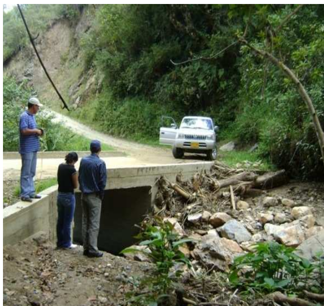
Fotografía N° 94: K8+0500, pontón en mal estado por creciente, se necesita destapar o construcción de un nuevo pontón sin el tabique, N1 32.359 W77 03.465.
