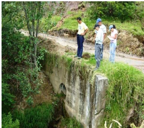
Fotografía N° 72: K4+0500, alcantarilla, fin de jurisdicción municipal de San Pedro De Cartago e inicia Arboleda, N1 30.774 W77 07.112.
