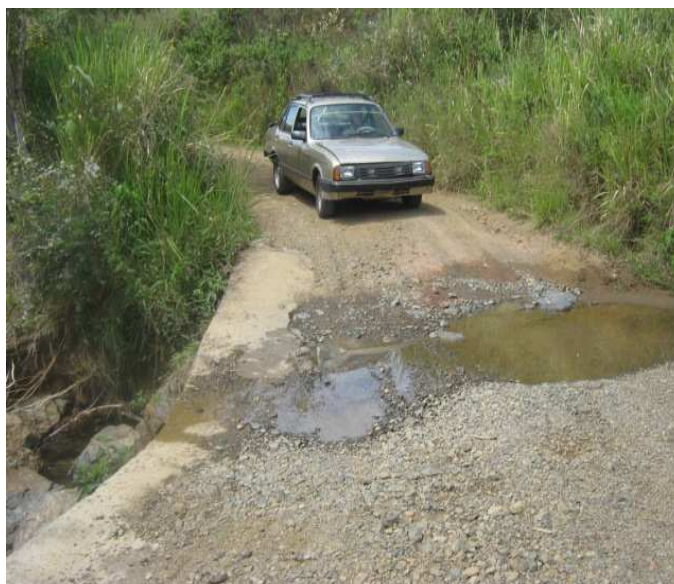
Fotografía N° 70: K10+0400, agua atraviesa la banca se necesita la construcción de una alcantarilla o pontón, N1 39.441 W77 10.613
