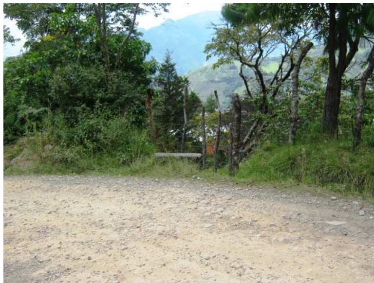
Fotografía N° 15: K2+0600, N1 30.610 W77 07.448, vegetación descontrolada, cunetas tapadas.
