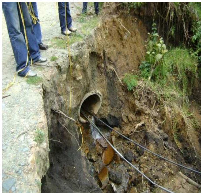
Fotografía N° 87: K3+0400, Caja de salida colapso debido a derrumbe, N1 31.867 W77 04.840
