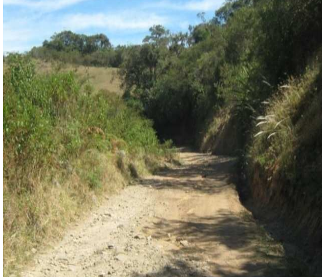
Fotografía N° 73: PR 3+0000, N1 30.989 W77 06.819, presencia de baches e irregularidades.
