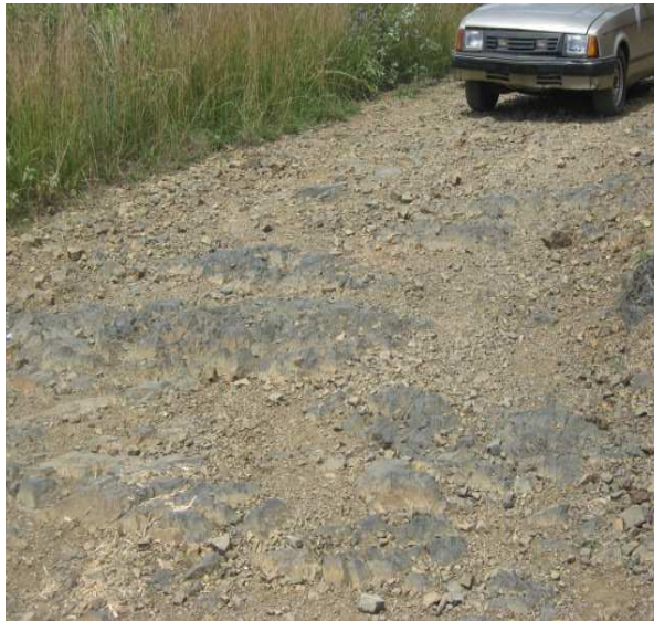
Fotografía N° 65: K16+0100, N1 39.167 W77 12.173. presencia de baches de gran tamaño, la vía presenta altas pendiente.
