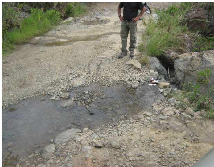
Fotografía N° 52: K5+0100, Gran cantidad de agua atraviesa la vía se necesita una alcantarilla o un pontón, N1 39.155 W77 09.811
