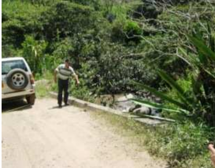
Fotografía N° 10: Pontón PR 3+0100 sobrecargado, necesita limpieza, N1 29.511 W77 09.183
