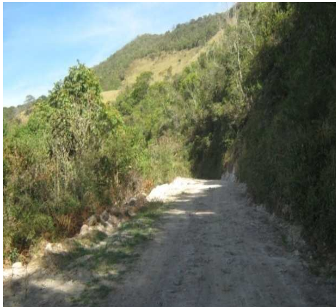
Fotografía N° 56: K3+0700, N1 37.924 W77 07.299, cunetas tapadas, material suelto.
