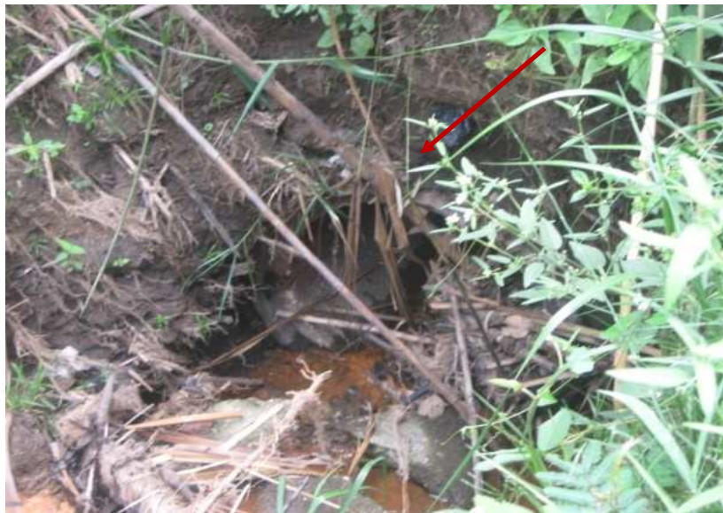
Fotografía N° 50: K3+0200, tubo de 16" se necesita construir una alcantarilla, N1 39.113 W77 09.212
