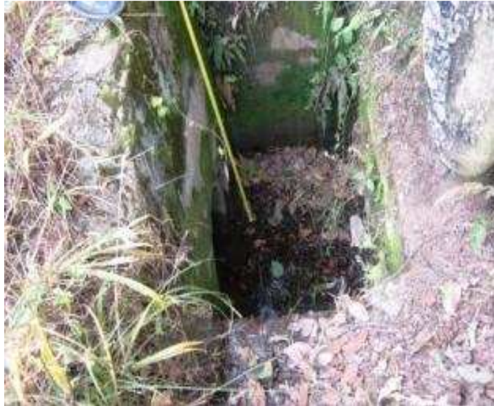
Fotografía N° 8 Caja de entrada alcantarilla sin mantenimiento PR 0+0050, N1 29.100 W77 08.637
