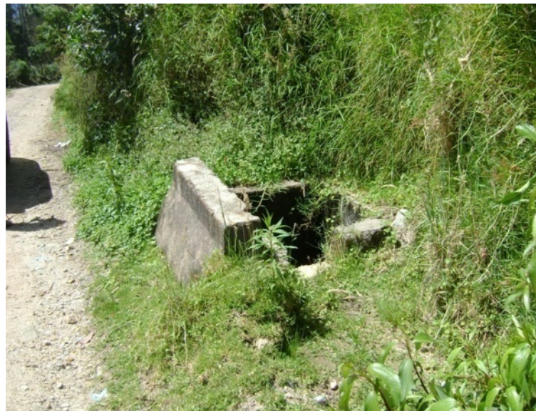
Fotografía N° 84: K2+0500, Caja de entrada de entrada de alcantarilla sin mantenimiento, N1 31.709 W77 05.074
