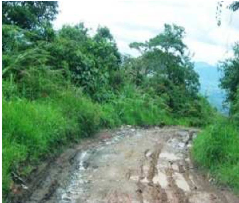
Fotografía N° 36: K9+0200, Requiere rocería en la vía y construcción de alcantarilla por presencia de agua en la banca, N1 34.721 W77 07.798
