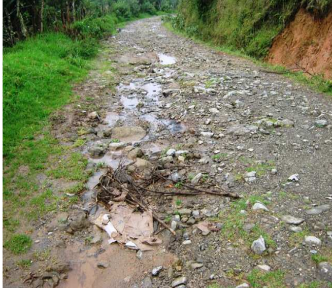
Fotografía N° 34: K3+0400, Se necesita la construcción de una alcantarilla debido a la presencia de agua en la banca, N1 32.943 W77 08.501
