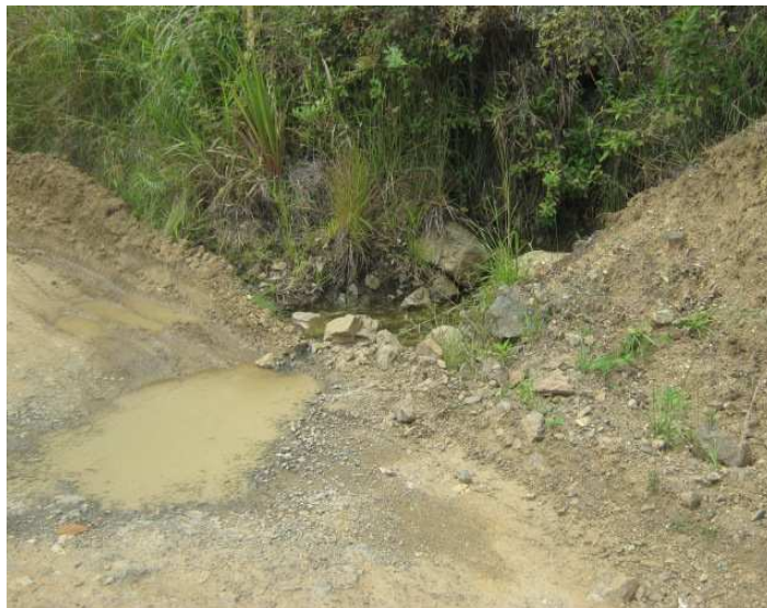
Fotografía N° 51: K3+0900, se necesita la construcción de una alcantarilla, presencia de agua en la banca, N1 39.132 W77 09.504
