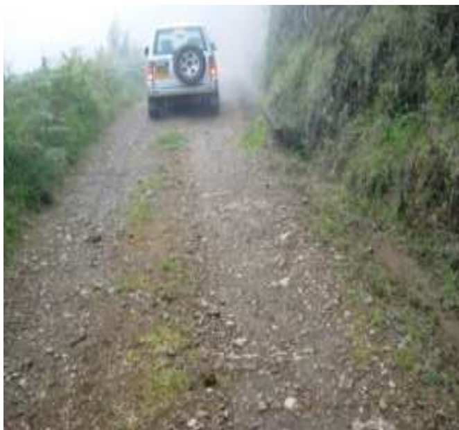
Fotografía N° 22: PR 3+0700, N1 31.727 W77 08.739, falta de afirmado, vegetación descontrolada, cunetas tapadas.
