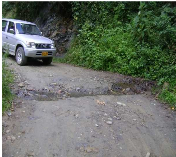
Fotografía N° 92: K8+0100, Presencia de agua en la banca, se requiere la construcción de una alcantarilla o de un pontón, N1 32.300 W77 03.561.
