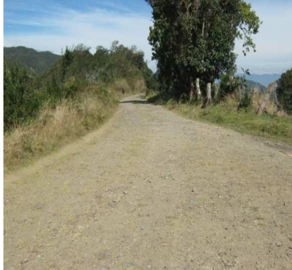
Fotografía N° 74: PR 4+0100, N1 30.779 W77 07.080, tramo en regular estado.
