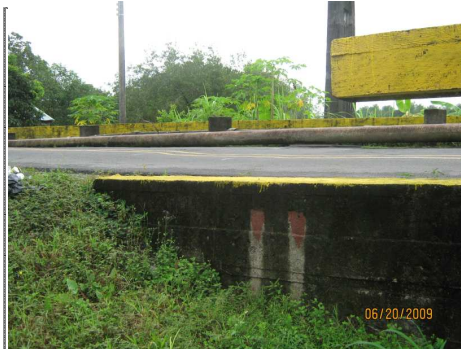
FOTO 3 HUNDIMIENTO EN ACCESO No. 1
