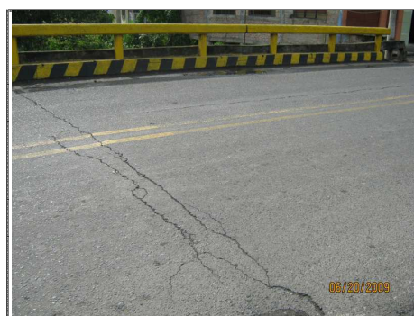
FOTO 4 SUPERFICIE, BARANDA LADO DERECHO Y JUNTA DE EXPANSION No 1
