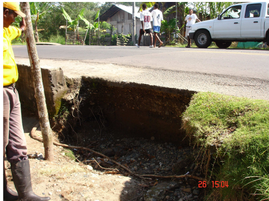
Fotografía 16. Lavado, erosión y socavación del suelo. PR 17+0300
