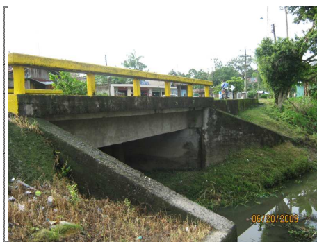
FOTO 4 BARANDAS, ALETA Y CONO No. 1 IZQUIERDO
