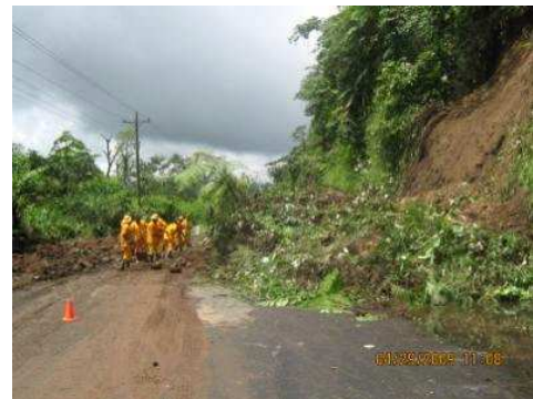
RUTA: 1001 TUMACO – JUNÍN PR 107 +000 ABRIL 29 DE 2009. REMOCION DE DERRUMBES
