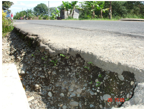
Fotografía 17. Lavado, erosión y socavación del suelo. PR 17+0270
