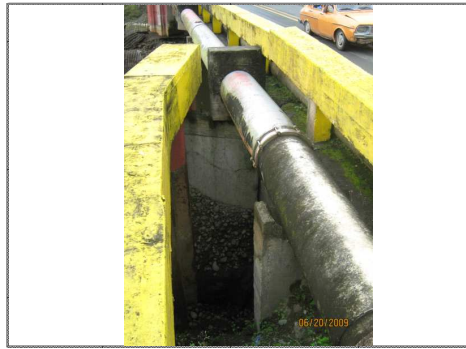
FOTO 2 HUNDIMIENTO Y PERDIDA DE MATERIAL EN EL CONO No 1 DERECHO
