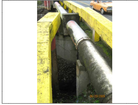
FOTO 2 HUNDIMIENTO Y PERDIDA DE MATERIAL EN EL CONO No 1 DERECHO
