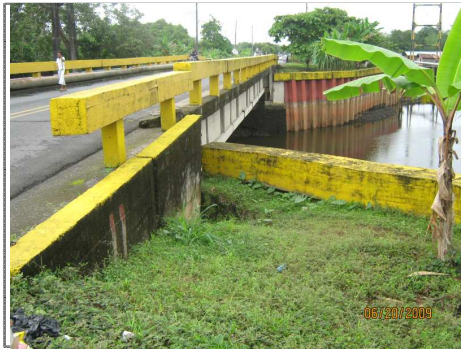
FOTO 1 BARNANDA Y HUNDIMIENTO EN EL CONO No 1 IZQUIERDO
