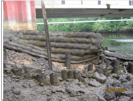
FOTO 7 EROSION Y SOCAVACION EN CIMENTACION
