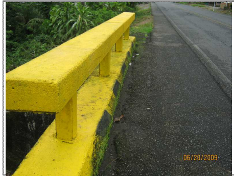
FOTO 2 BARANDAS LADO IZQUIERDO
