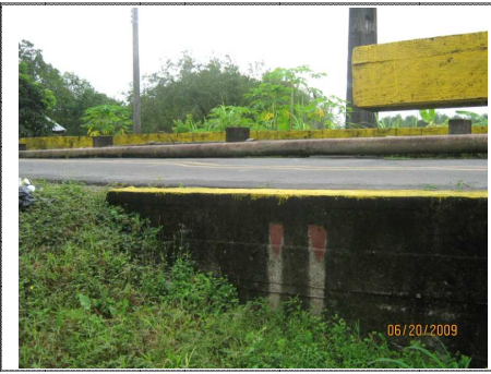
FOTO 3 HUNDIMIENTO EN ACCESO No. 1
