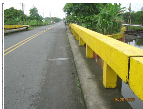
FOTO 10 VISTA A BARANDAS LADO IZQUIERDO Y ACCESO No 1
