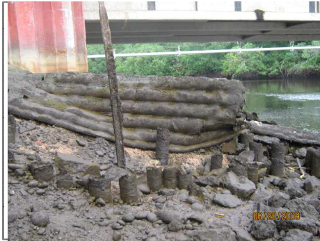
FOTO 7 EROSION Y SOCAVACIÓN EN CIMENTACION
