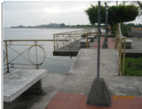
FOTO 9 BARANDAS - FRACTURAS DE ELEMENTOS
