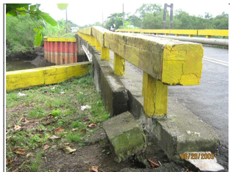
FOTO 4 VISTA DE CONO No.2 IZQUIERDO Y FRACTURA EN ELEMENTOS DE BARANDAS Y BORDILLOS
