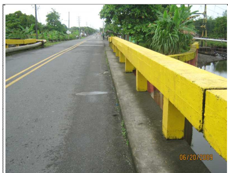
FOTO 10 VISTA A BARANDAS LADO IZQUIERDO Y ACCESO No 1
