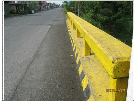
FOTO 2 BARANDA LADO DERECHO
