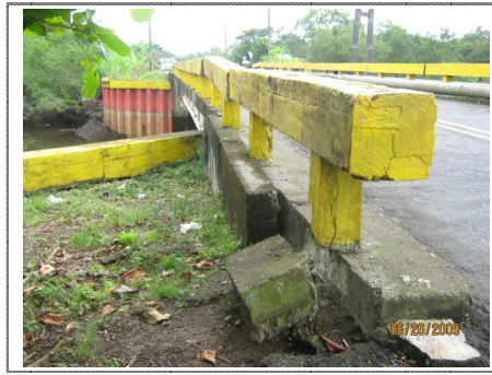
FOTO 4 VISTA DE CONO No.2 IZQUIERDO Y FRACTURA EN ELEMENTOS DE BARANDAS Y BORDILLOS
