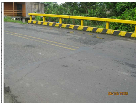
FOTO 5 SUPERFICIE DEL PUENTE Y JUNTA DE EXPANSION
