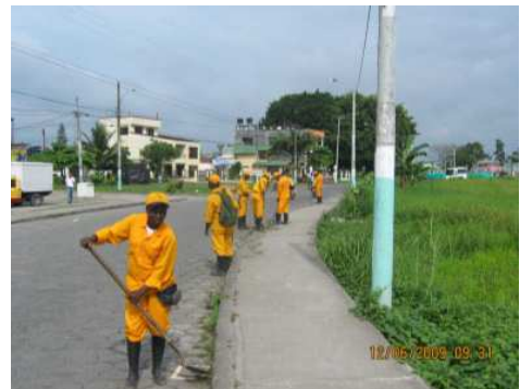
RUTA: 1001 TUMACO – JUNÍN JUNIO 12 DE 2009. PR 9+0500. LIMPIEZA DE ALCANTARILLAS , CANALES Y SUMIDEROS
