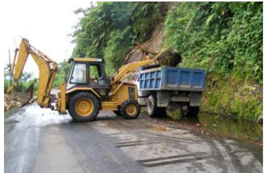
RUTA: 1001 TUMACO – JUNÍN PR 107+0000, 20 DE MAYO DE 2009 REMOCIÓN DE DERRUMBE
