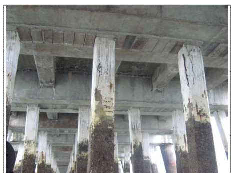
FOTO 4 VISTA DE PILAS CON FALLAS DE RESISTENCIA
