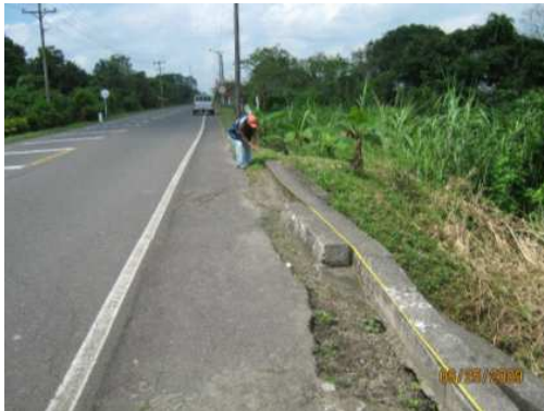
RUTA: 1001 TUMACO – JUNÍN PR 20+0950, 25 DE JUNIO DE 2009 CUANTIFICACIÓN DE DAÑOS EN LA VÍA.
