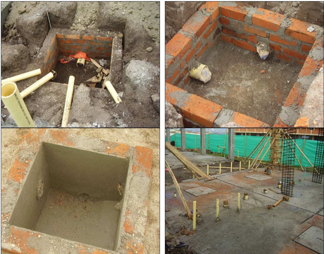
Figura 8. Desagües e instalaciones subterráneas
