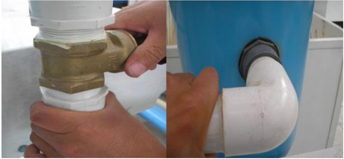
Figura 43 codo de entrada al mezclador Y Válvulas de compuerta
