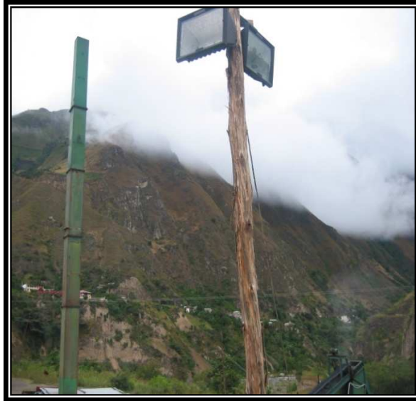
Imagen 10. Pantallas de iluminación.
