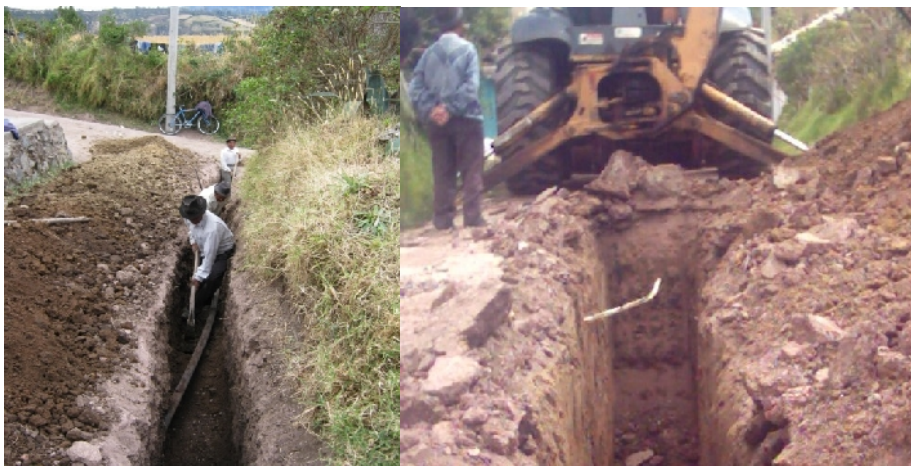
Figura 68. Tubería de agua potable y riego.
