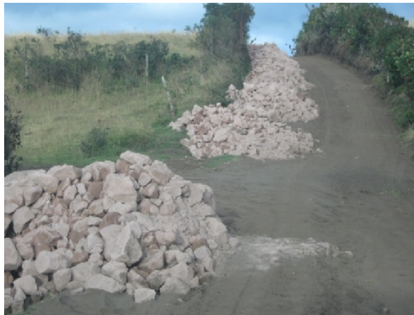
Figura 37. Acordonamiento Vía San Vicente-San Miguel.
