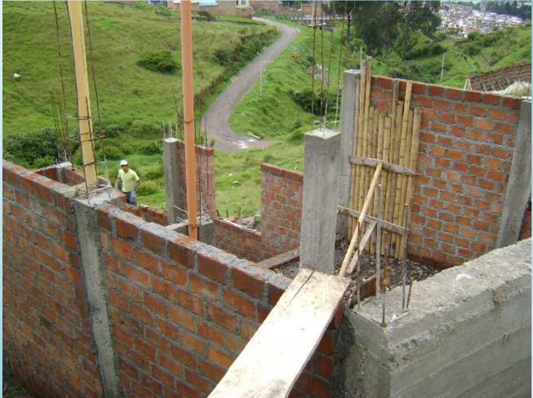
Figura 18. Obra que no cumple con los refuerzos.de los elementos estructurales.
