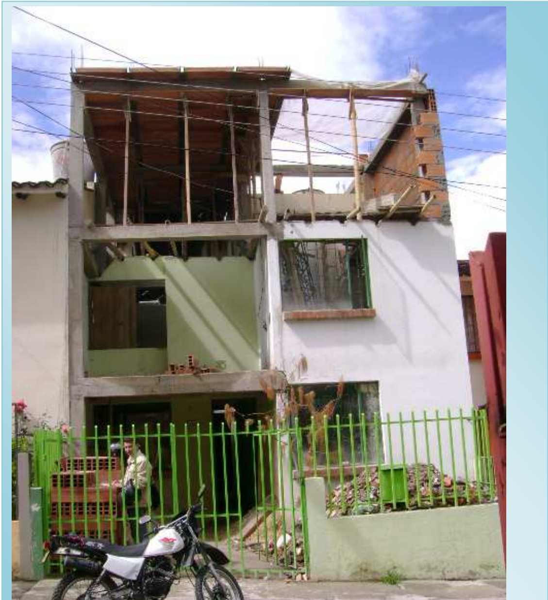
Ampliación sin licencia ubicada en el barrio Los Alcázares. En este tipo de obras se pueden comprometer las estructuras a ser intervenidas o cargadas sin estudios previos.
