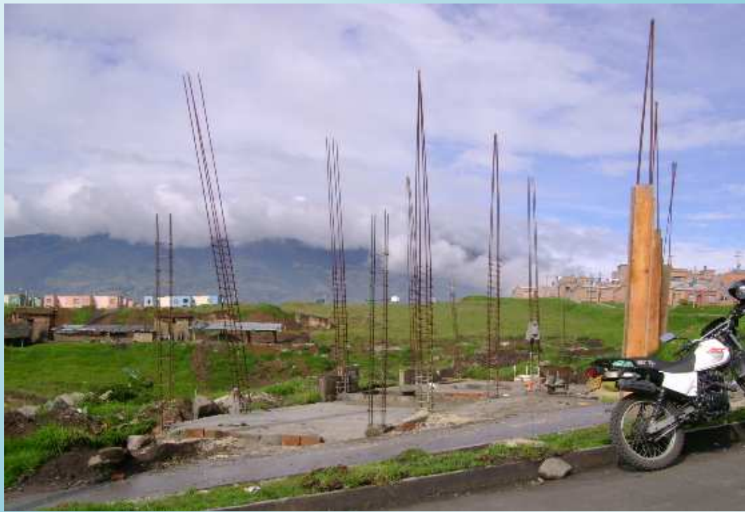
Figura 19. Obra que no cumple con los especificaciones de refuerzo
