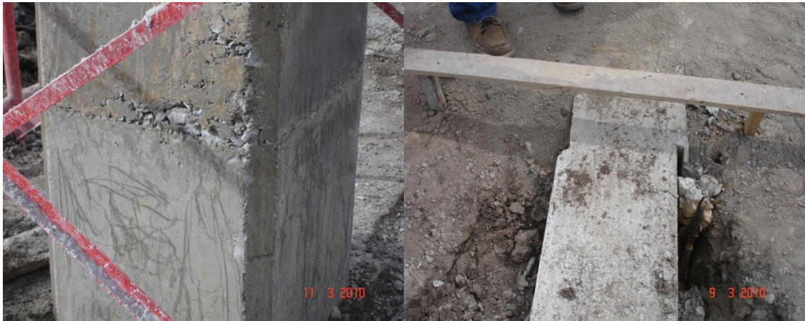
Fotografías 58 y 59. Presencia de mayor agregado, fallas en la alineación y hormigueros.
