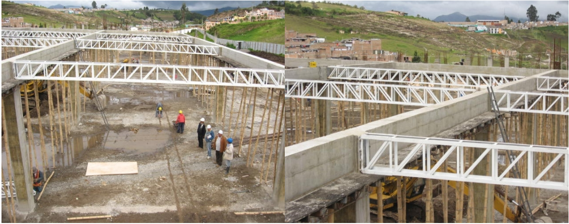
Fotografías 44 y 45. Cercha metálica, las cerchas se montan sobre la platina cuyos pernos de sujeción se soldaron al acero de la viga.
