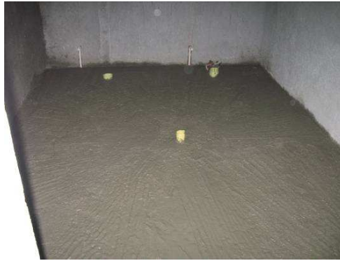
Imagen 125. Placa de piso en concreto
