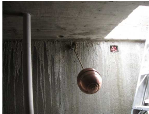
Imagen 107. Tubería de succión y flotador.
