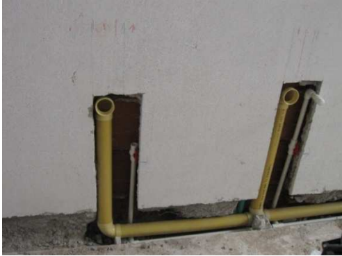
Imagen 24. Tubería presión 1/2" y sanitaria 2"
