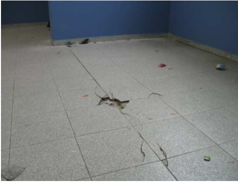
Imagen 96. Estado inicial de la cerámica
