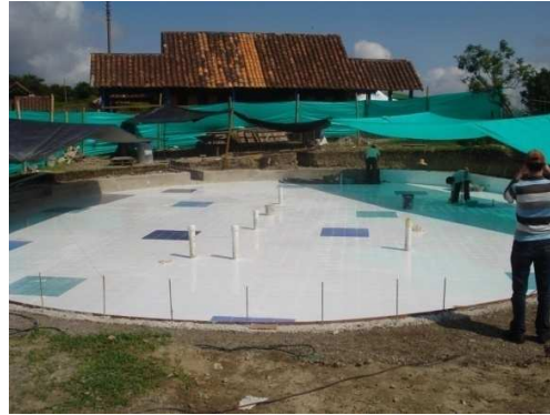
Imagen 334. Instalación hidráulica juegos interactivos.
