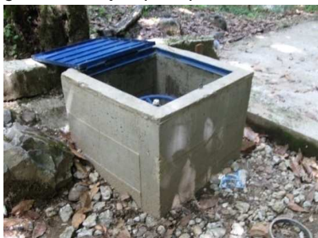
Imagen 163. Cajilla para protección de válvula.
