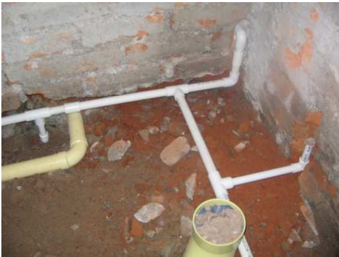
Imagen 208. Punto hidráulico y tubería presión 1/2.
