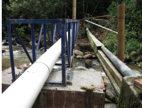
Imagen 170. Tubería PVC presión 8"
