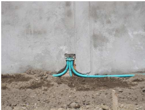
Imagen 213. Salida para toma corrientes
