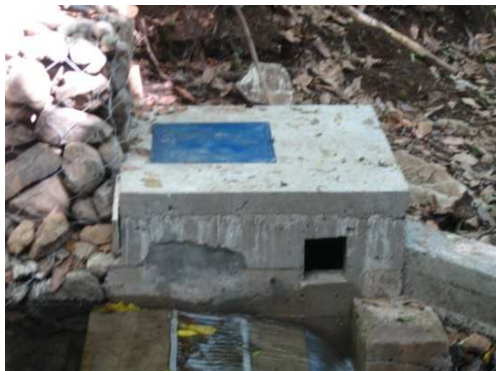
Imagen 161. Cajilla de captación.
