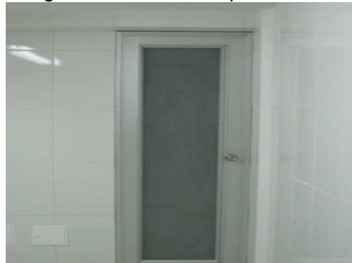
Imagen 68. Puerta Trampa De Grasas.
