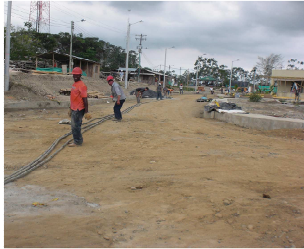
Foto 38 Cable para acometida de 34.5
