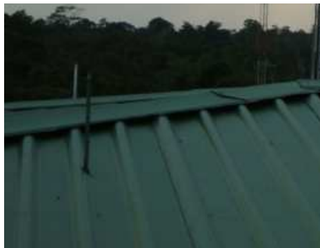
Foto 36 Puntas captación de rayos.
