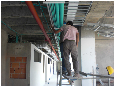
Foto 39 Ductos porta cables.
