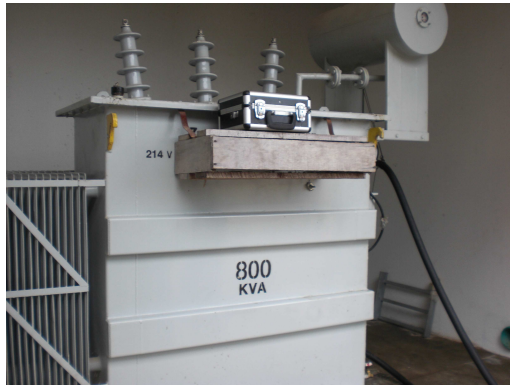
Foto 34 Transformador de 800 Kva.
