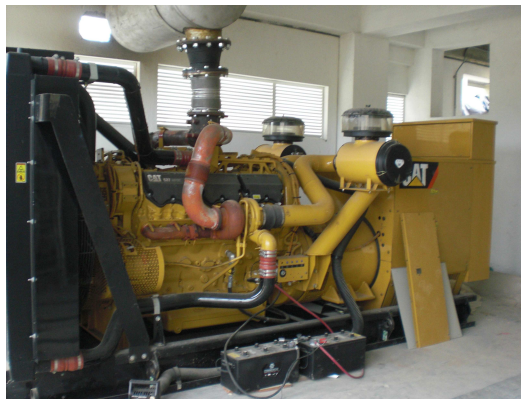
Foto 35 Planta de 800 Kva.
