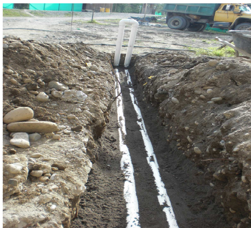
Foto 28 Red general de agua fría presión
