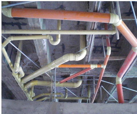
Foto 33 Red interna de aguas negras
