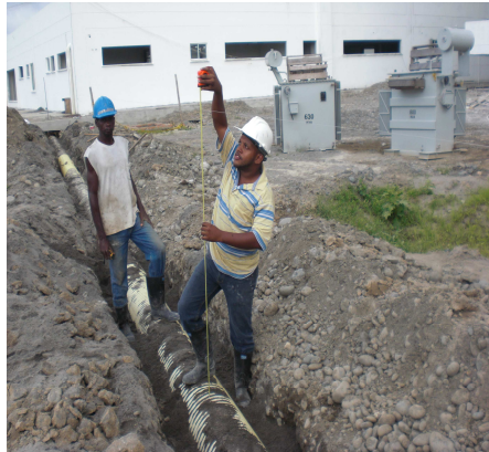
Foto 32 Red exterior de aguas negras
