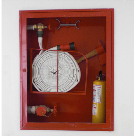
Foto 29 Gabinete de la red contra incendios
