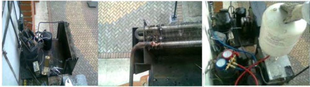
Figura 4. Unidad condensadora, Cuarto frio 1, Área Microbiología.
