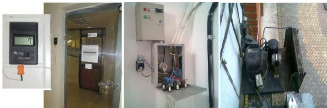
Figura 3. Cuarto frio, piso 1, área de microbiología.
