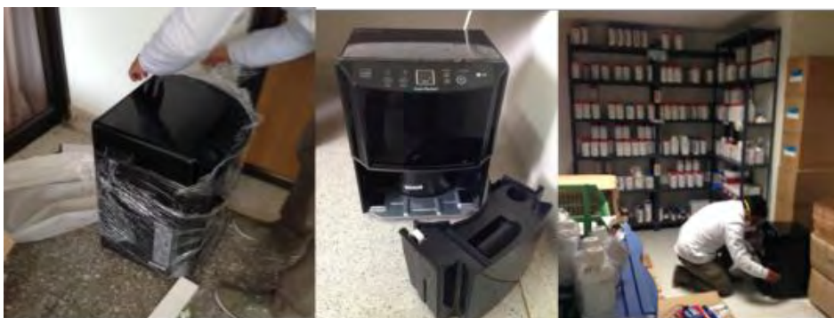
Figura 15. Instalación Deshumidificador para controlar la humedad en los laboratorios de microbiología y en el almacén de reactivos
