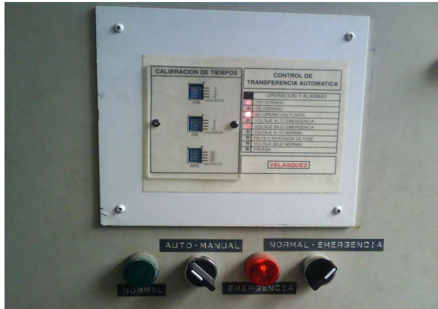
Fotografía 1. Tablero de control para la planta de apoyo automático
