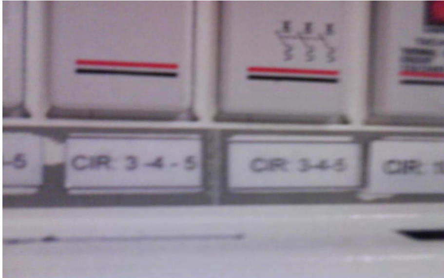
Fotografía 3. Numeración del tablero normal de tomacorrientes
