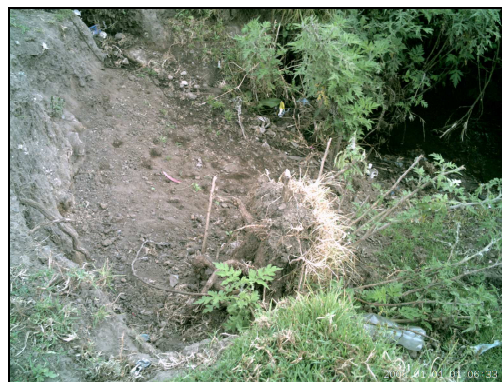
Figura 21. Deslizamiento vía vereda Santa Bárbara.
