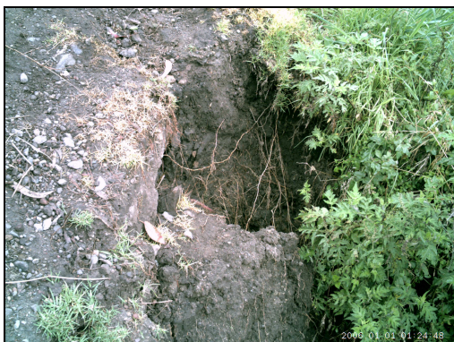
Figura 20. Derrumbe vía vereda Santa Bárbara.
