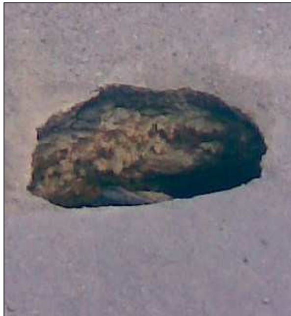
(Figura 58) “Daño a Pavimento por falla del Box Couverts, Frente Hospital Infantil”. Fuente: Esta investigación.
