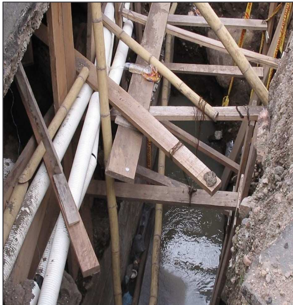
(Figura 56) “Daño a vía por falla en la estructura del Box Coulverts”. Cra. 29 con Calle 14. Bomboná Fuente: Esta investigación.
