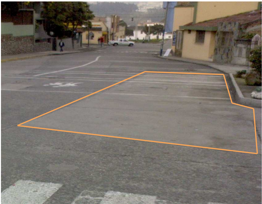
(Figura 47) "Parche realizado por EMPOPASTO al pavimento por colapso que tuvo el box couverts en el sector frente al colegio NORMAL". Fuente: Esta investigación.
