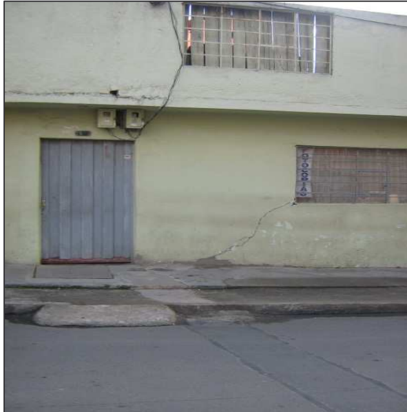
(Figura 55) “Daño a vivienda por falla en la estructura del Box Coulverts”. Cra. 29 con Calle 14. Bomboná Fuente: Esta investigación.
