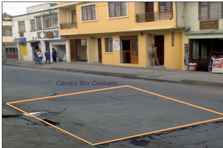
(Figura 53) "Deterioro de vía por el trayecto del Box Coulverts" Calle 15 con Cra. 29 Bomboná. Fuente: Esta investigación.
