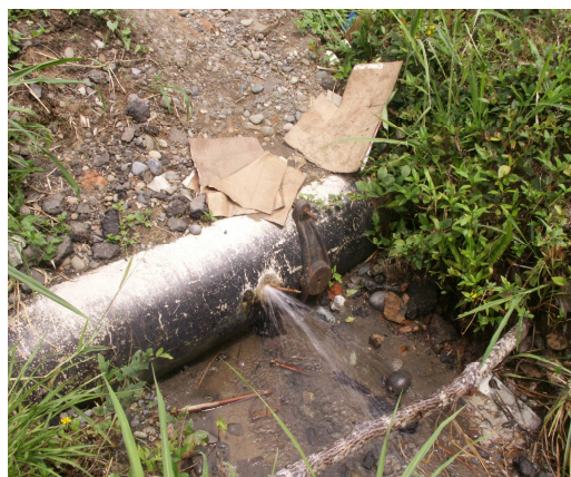
Figura 14. Línea de conducción de agua tratada
