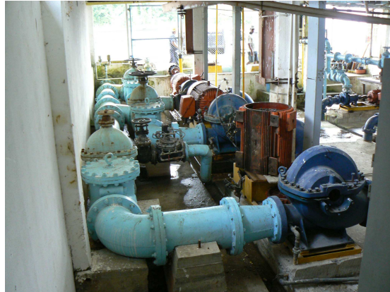
Figura 13. Estación de bombeo de agua tratada
