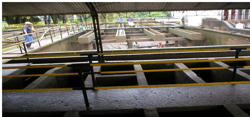
Fuente: Tashy 2006. Planta de tratamiento, buchely km 22 tumaco pasto
