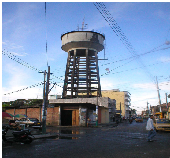
Figura 3. Tanque de Almacenamiento de Agua
