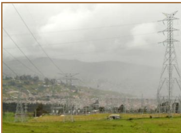
Figura 62. Subestación eléctrica, Barreras verdes
