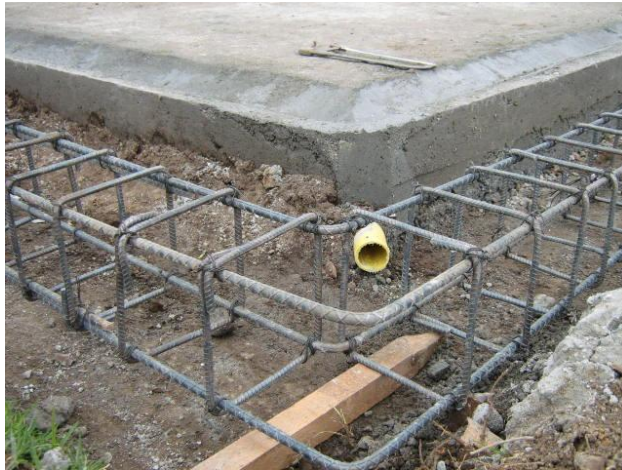
Figura 14. Cuneta y la conexión en tubo de 4”.
