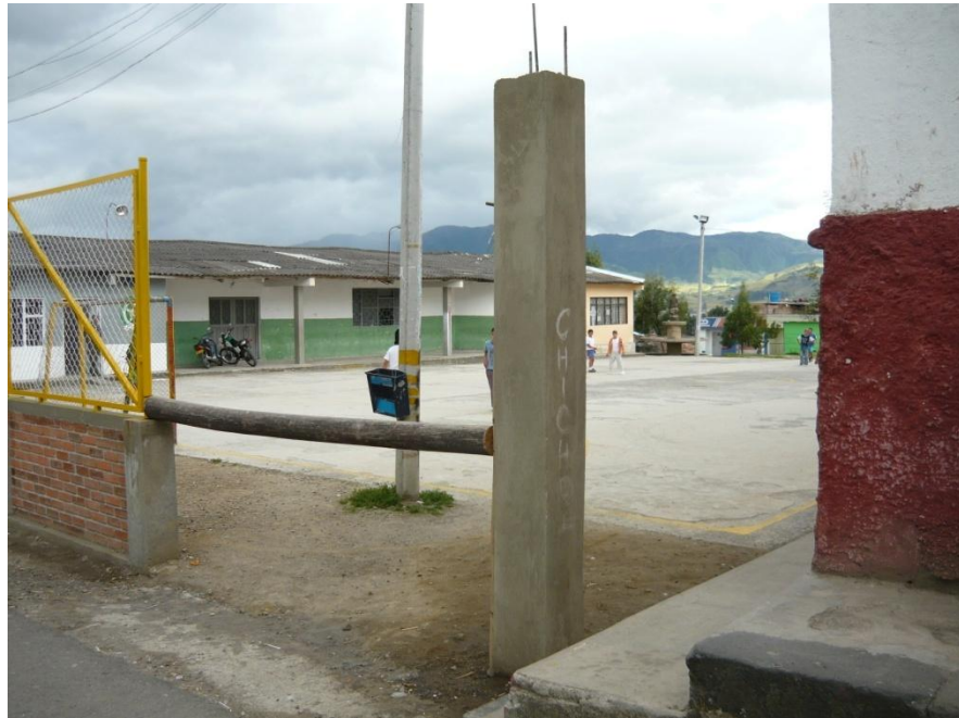
figura 106. Columna no contemplada inicialmente.
