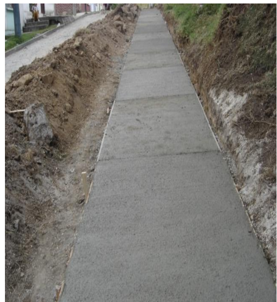
Figura 44. Andén totalmente fundido.
