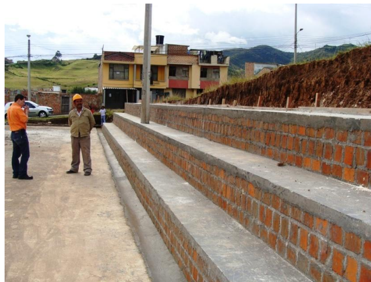
Figura 79. Graderías construidas sin repello.
