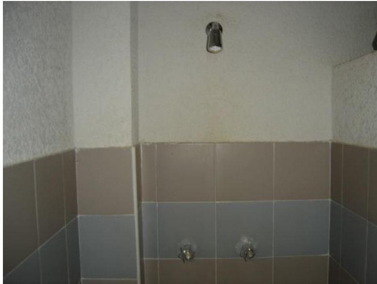
Figura 52. Duchas con mezclador instaladas.
