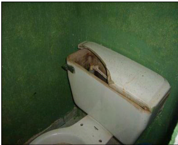
Foto 5: Servicio en mal estado.
