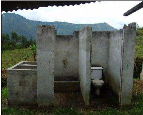
Foto 1: Unidad sanitaria fuera de servicio.
