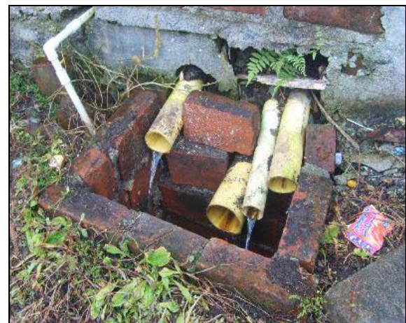
Foto 8: Caja de salida deteriorada.
