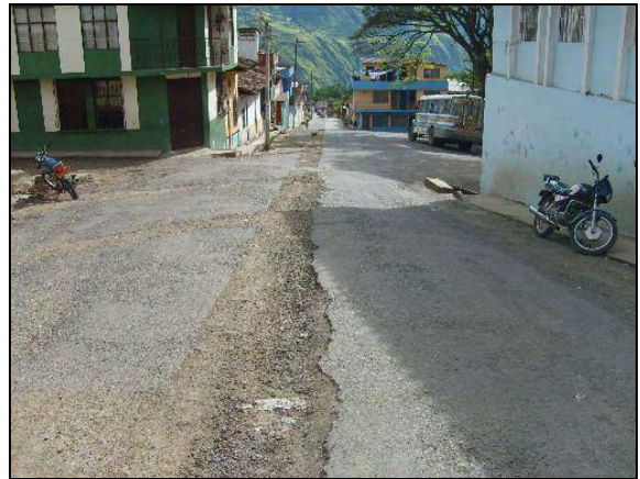
Foto 45: Tramo vial deteriorado.
