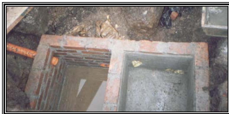
Figura 53. Cajas de inspección
