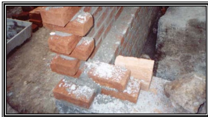
Figura 68. Muro de contención en ladrillo tizón
