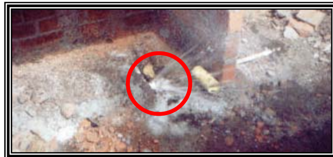
Figura 57. Detalle de tubería con fuga
