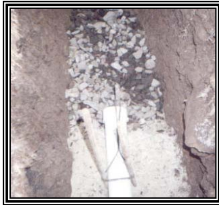
Figura 4. Red sobre filtro de arena
